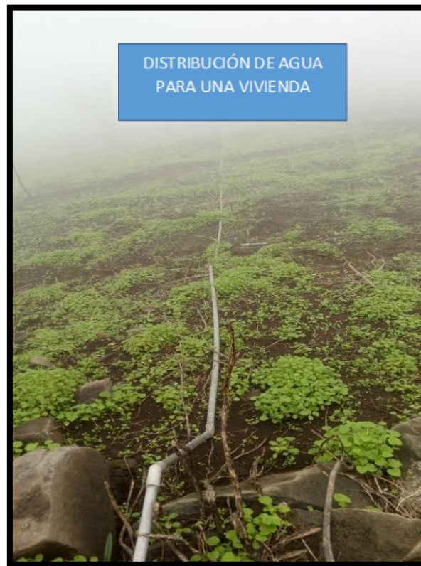
Figura 24 , distribución de agua para la vivienda (provisional).
