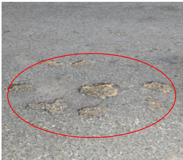
Fotografía: Deterioro dentro de los 3700 m de la prog. +15+000, sentido Oeste- Este, se observa deterioro tipo B (Ojo de pescado, código: O)
