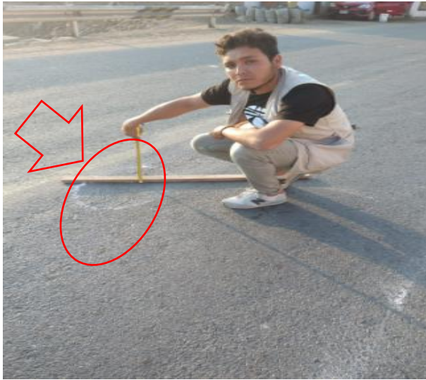
Fotografía: Deterioro dentro de los 200 m iniciales de la prog.13+000, sentido Oeste- Este, se observa deterioro tipo A (Depresiones o Hundimientos longitudinales, código: DL)
