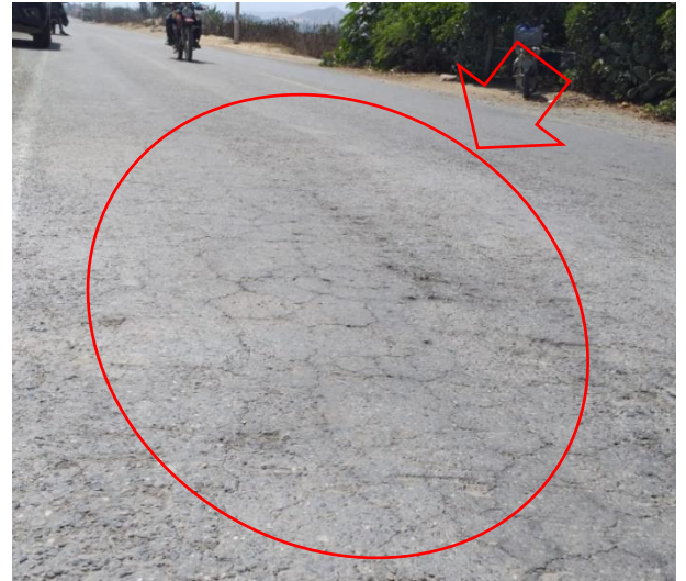
Fotografía: Deterioro dentro de los 200 m iniciales de la prog.13+000, sentido Oeste- Este, se observa deterioro tipo A (Fisura piel de cocodrilo, código: FPC)
