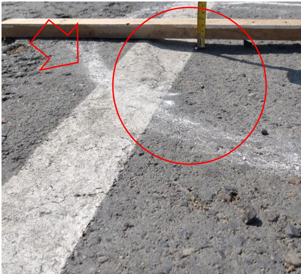
Fotografía: ahuellamiento de baja severidad con una medida entre 13 mm a 25 mm
