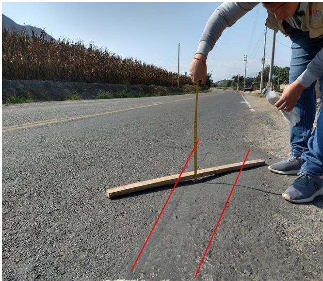
Fotografía: Muestra n°10 (punto 90), presencia de depresión, exudación en la prog: 15+828.7
