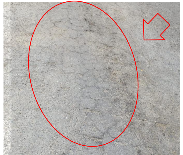
Fotografía: Deterioro dentro de los 3300m de la prog. 16+000, sentido Oeste- Este, se observa deterioro tipo B (Fisura de contracción térmica, código: FCT)
