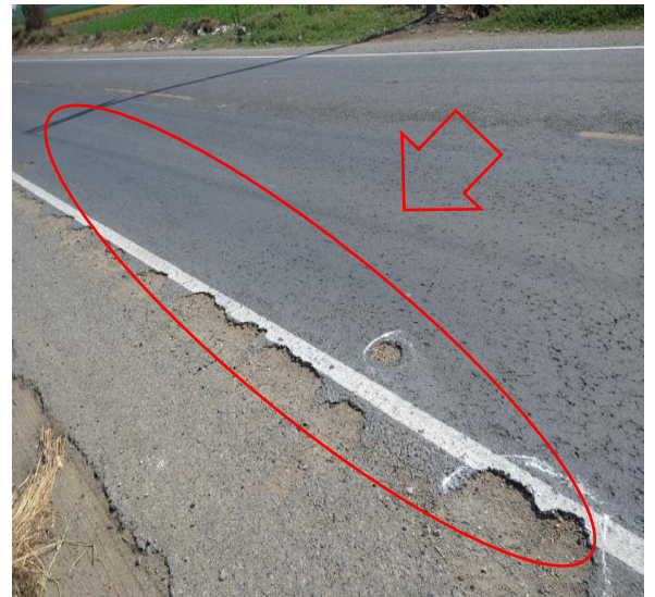
Fotografía: fisura de borde de severidad considerado a lo largo de borde de calzada
