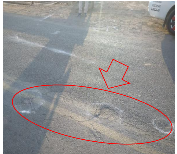
Fotografía: abscisa 30 de los 100 m iniciales de la prog.13+000, sentido Este- Oeste, se observa deterioro tipo A (Depresiones o Hundimientos longitudinales, código: DL)
