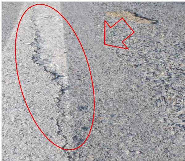
Fotografía: abscisa 30 de los 100 m iniciales de la prog.13+000, sentido Oeste - Este, se observa deterioro tipo B (Fisura de borde, código: FB)
