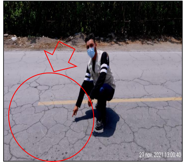
Fotografía: Falla tipo piel de cocodrilo
