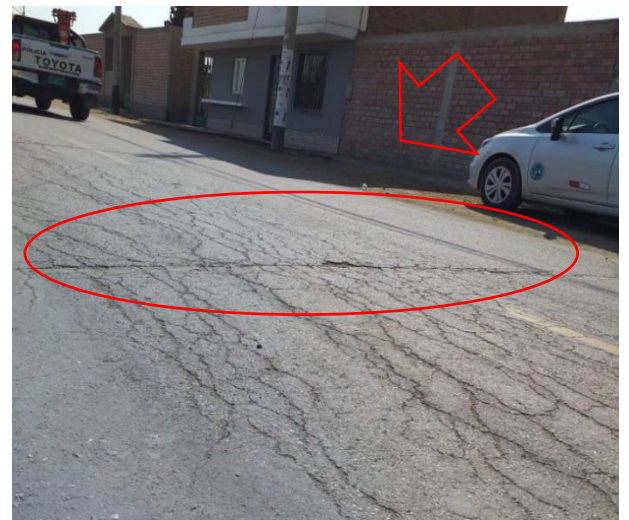
Fotografía: Deterioro dentro de los 300 m de la prog.13+000, sentido Oeste- Este, se observa B (fisura transversal)
