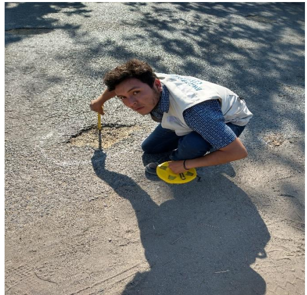
Fotografía: Punto n° 11 (punto 99) presencia piel de huecos, piel de cocodrilo, exudación, en la prog: 16+111.3
