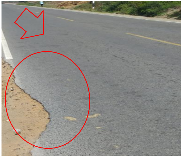
Fotografía: Deterioro dentro de los 3800 m de la prog.16+000, sentido Este - Oeste, se observa deterioro tipo B (Desintegración de borde del pavimento, código: DB)
