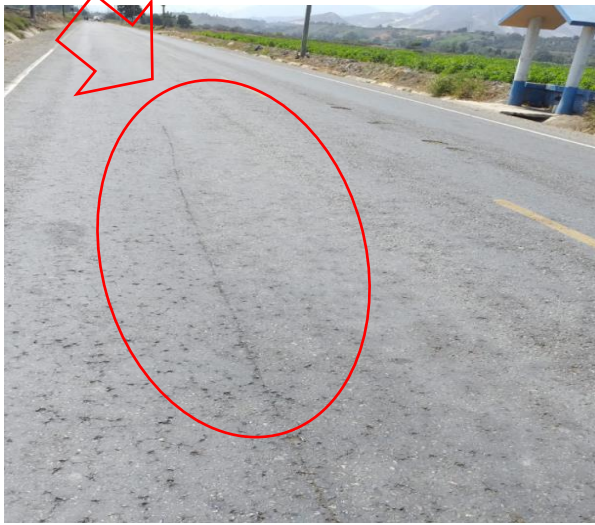
Fotografía: Deterioro dentro de los 3500 m de la prog.15+000, sentido Oeste- Este, se observa deterioro tipo B (Fisura longitudinal por fatiga, código: FLF)
