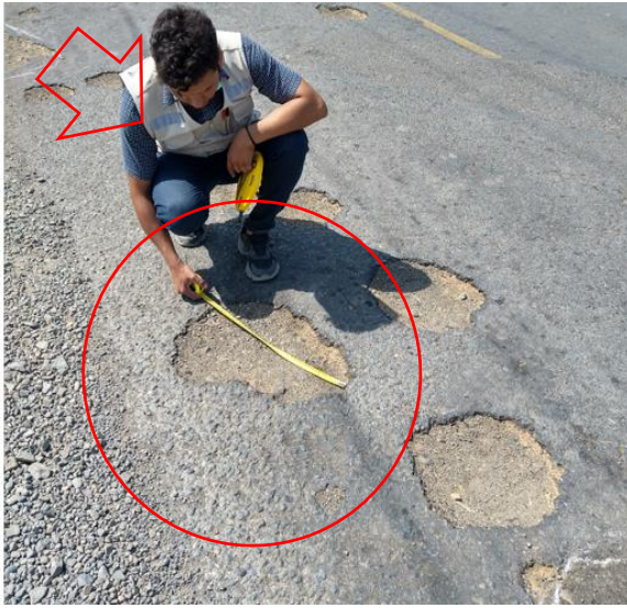
Fotografía: : Deterioro dentro de los 3500 m de la prog. +15+000, sentido Sur- Este, se observa deterioro tipo B (Ojo de pescado, código: O)
