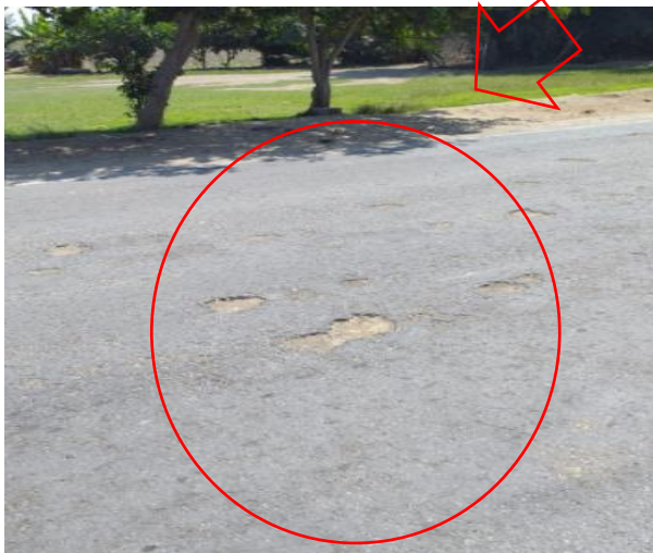
Fotografía: Deterioro dentro de los 3800 m de la prog.16+000, ambos sentidos, se observa deterioro tipo B (Ojo de pescado, código: O)
