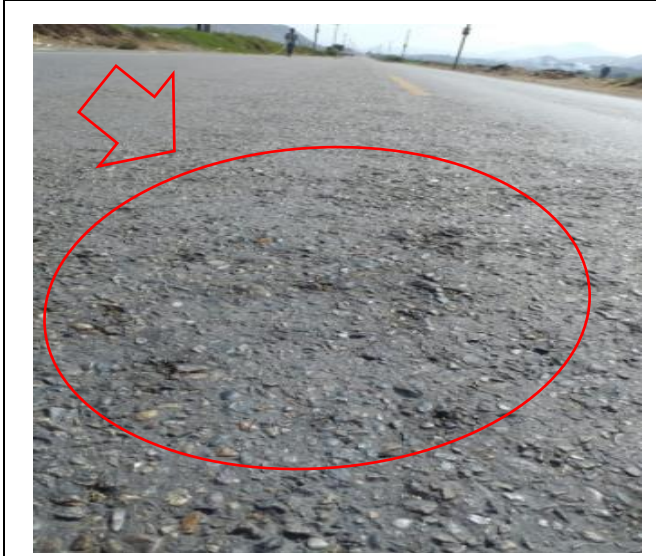
Fotografía: Deterioro dentro de los 1400 m de la prog.14+000, sentido Oeste- Este, se observa deterioro tipo B (Pulimientos de agregados, código: PU)
