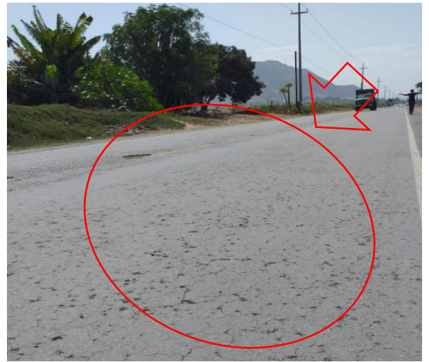
Fotografía: Deterioro dentro de los 1600 m de la prog.14+000, ambos sentidos, se observa deterioro tipo B (Segregación, código: C)
