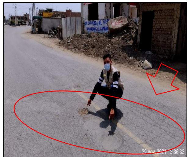
Fotografía: Falla tipo parches y huecos
