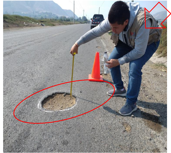
Fotografía: Deterioro dentro de los 350000 m de la prog. +15+000, sentido Sur- Este, se observa deterioro tipo B (Ojo de pescado, código: O)
