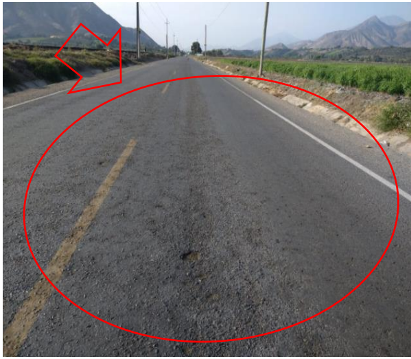
Fotografía: Deterioro dentro de los 2800 m de la prog. 15+000, sentido Oeste- Este, se observa deterioro tipo B (Segregación, código: S)
