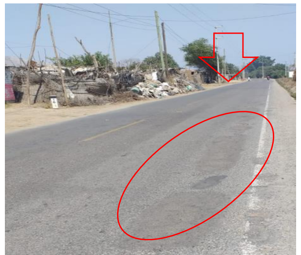
Fotografía: Deterioro dentro de los 2500 m de la prog.15+000, sentido Oeste- Este, se observa deterioro tipo B (Bacheo y Parcheo, código: B)
