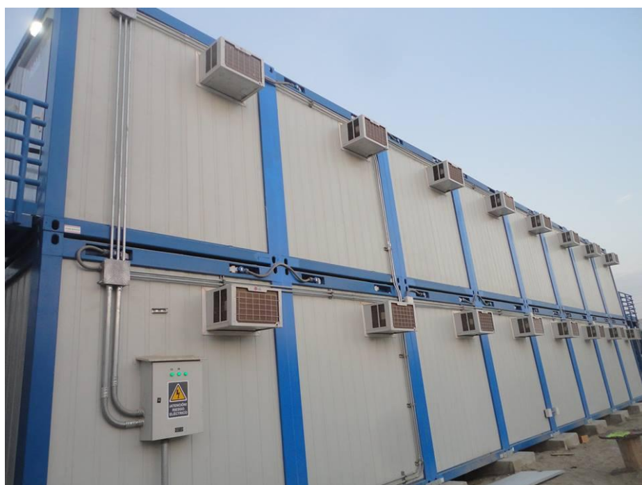
Aires Acondicionados instalados en el SENATI – Piura
