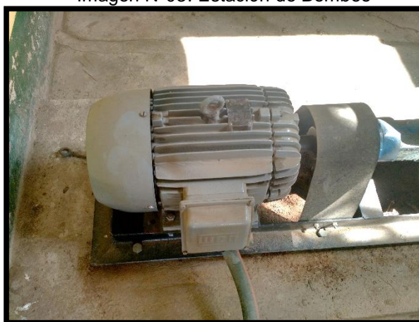
Imagen N°03: Estación de Bombeo
