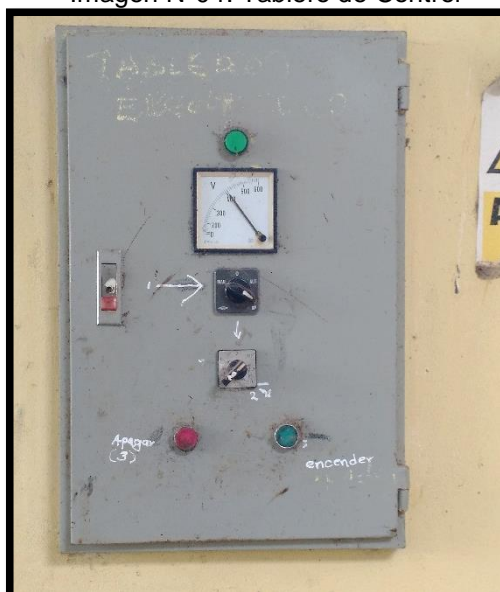
Imagen N°04: Tablero de Control
