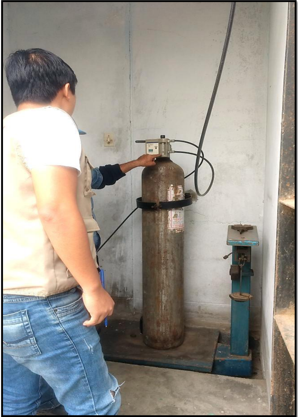
Fotografía N°20: Explicación del funcionamiento de la distribución de la clorificación.
