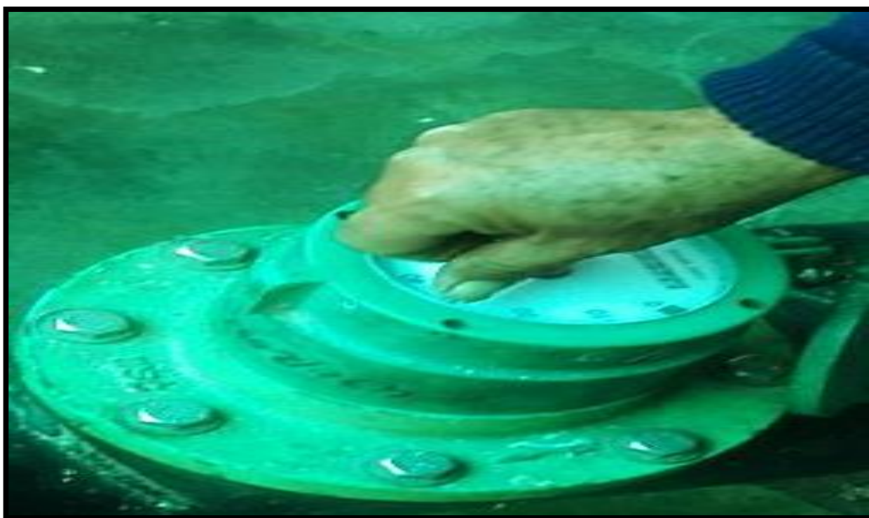
Fotografía N°17: Explicación del operador técnico sobre el funcionamiento del caudalímetro.
