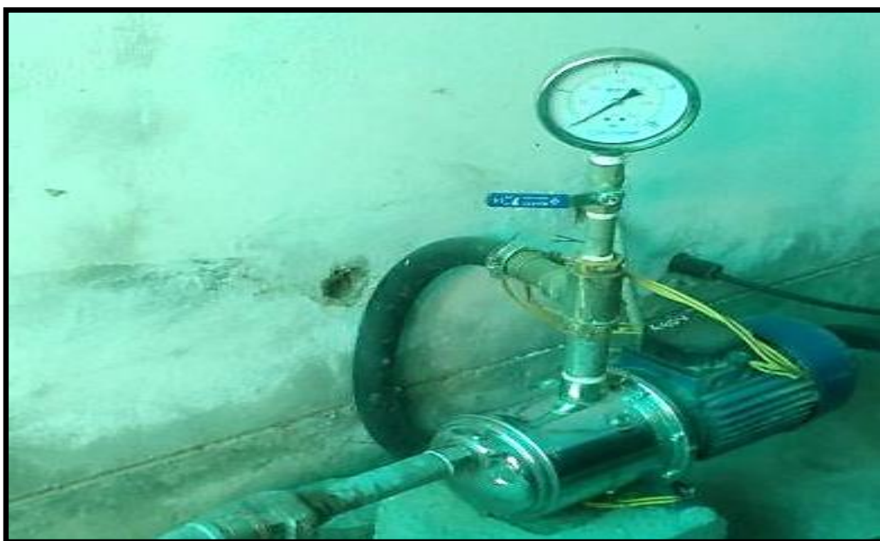
Fotografía N°18: Electrobomba que administra la clorificación del agua.
