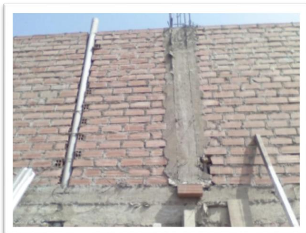
Figura 20. Tuberías mal diseñadas en su ubicación
