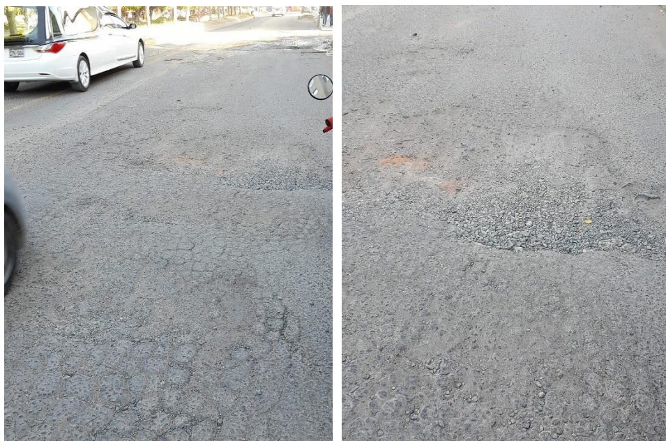
Figura 2. Vía en mal estado de la Av. Gran Chimú
