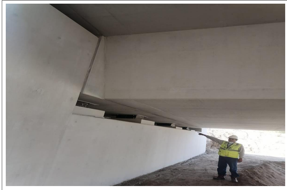
Figura 23. Identificación de los aisladores del puente Grau, Piura 2022.
