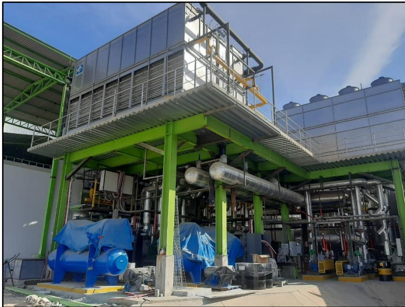
Figura 1: Sala de máquina de una planta industrial - Proanco
