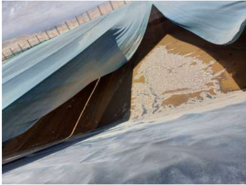
Imagen 7. Capacidad de almacenamiento baja del reservorio.
