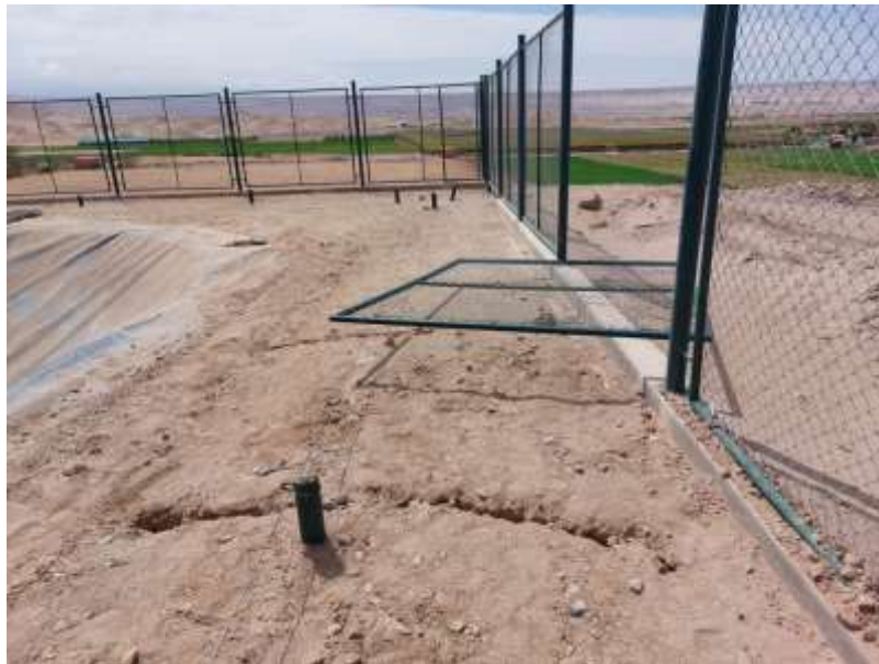
Imagen 8. Grieta en la corona a la salida parte baja del reservorio
