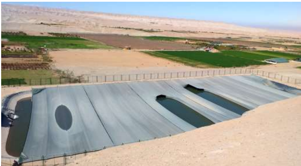
Imagen 1. Estado situacional del reservorio.
