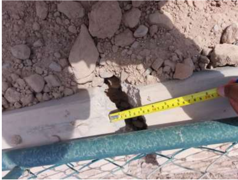
Imagen 9. Medición con el Flexómetro de la grieta de 3 pulgadas.
