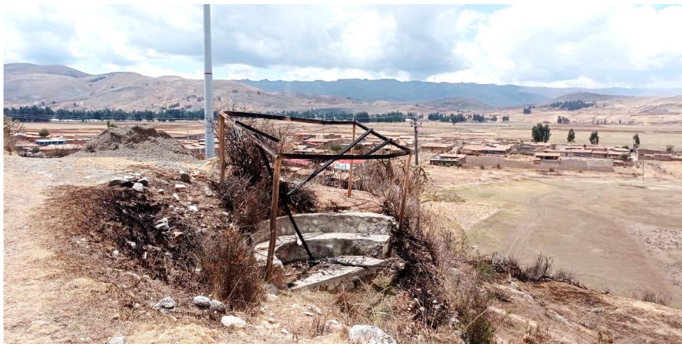
Ilustración 32: Evidencia de destrucción de infraestructura creada por el Programa Social Lurawi Perú para el Mirador de Tragadero. Comunidad Campesina de Tragadero
