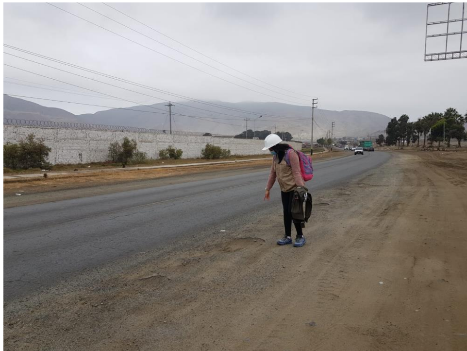
Figura 55. Erosión de las bermas en el carril derecho
