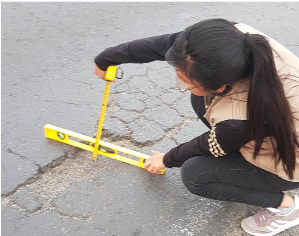
Figura 60. Hueco y piel de cocodrilo severidad alta
