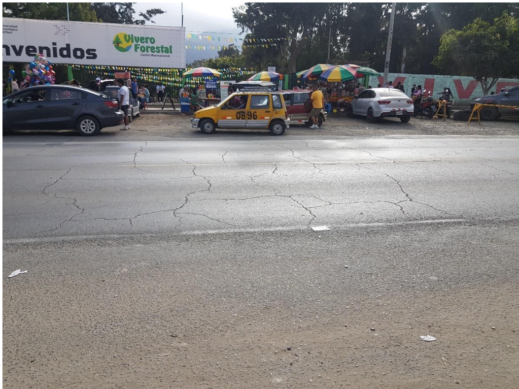
Figura 63. Agrietamiento en bloque severidad media
