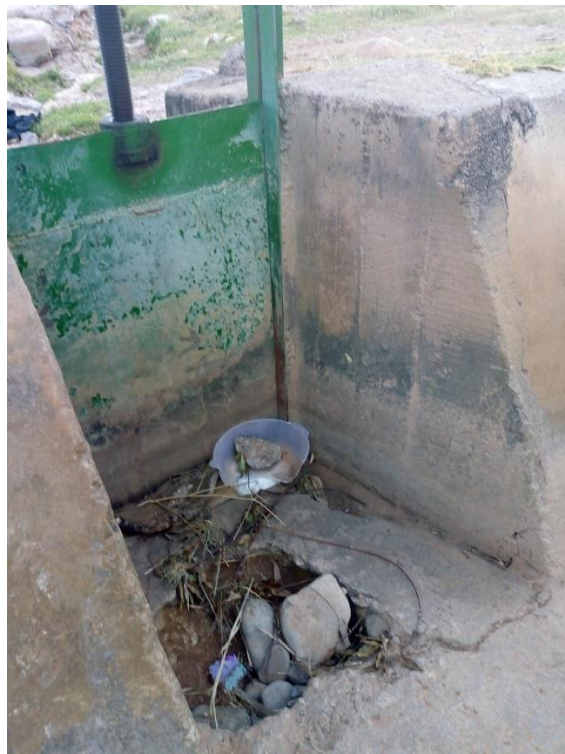
Figura 16: Mala instalación de la compuerta
