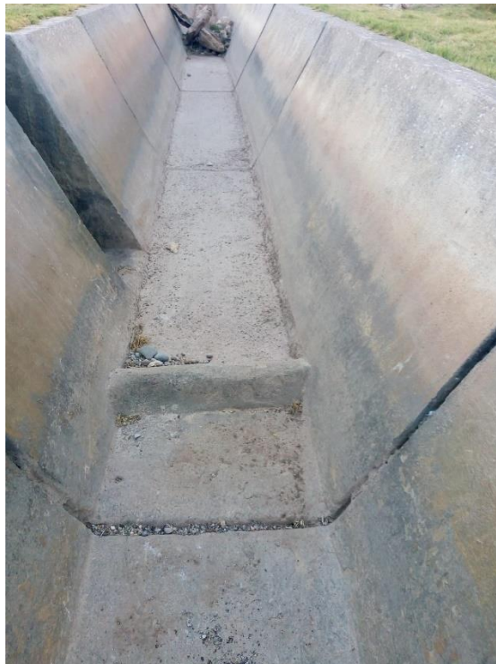
Figura 18: Obstrucción de paso del agua
