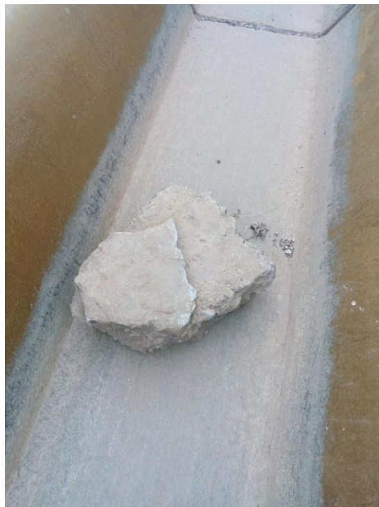
Figura 22: Presencia de desmorte
