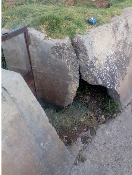
Figura 19: Compuerta con mala instalación
