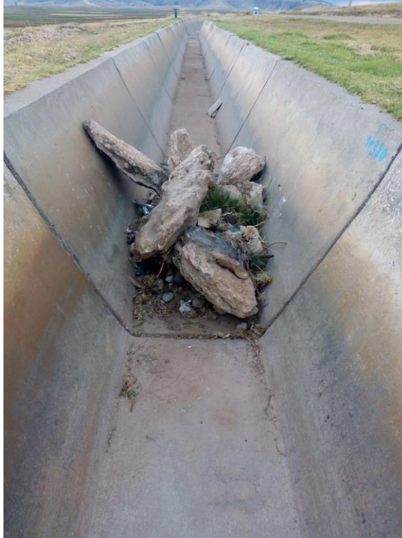
Figura 15: Presencia de Desmorte
