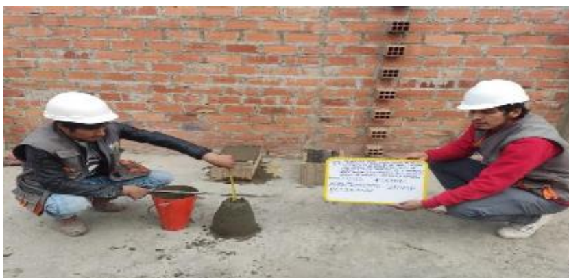
Figura 72. Proceso de mezclado de concreta adición de 0% tallo de altramuz y Prueba de revenimiento
