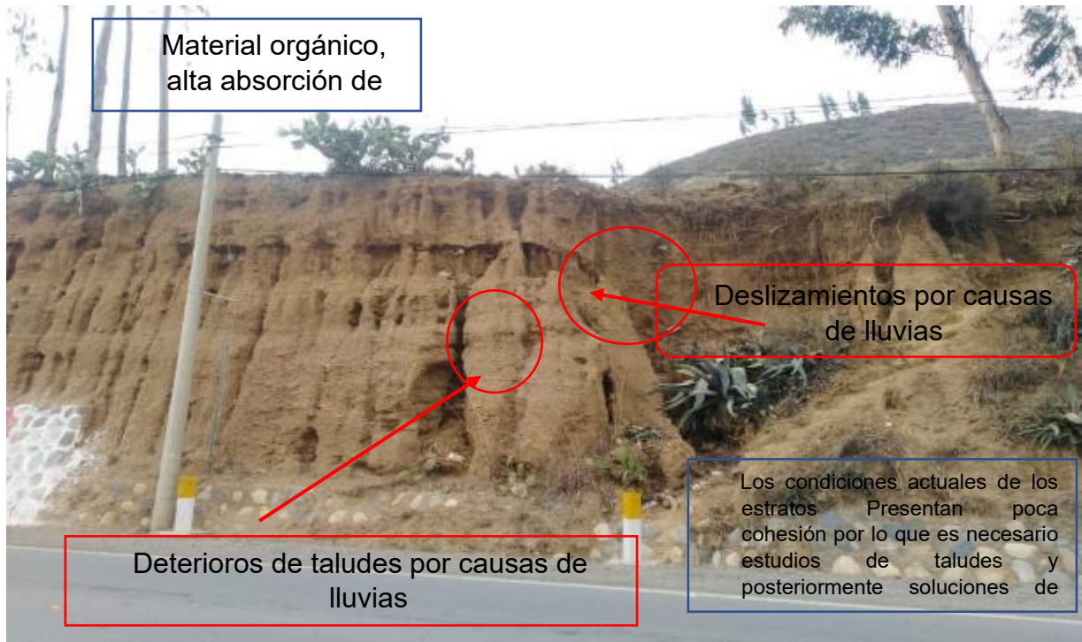
Figura 5. Causas de los deslizamientos del estado de situación
