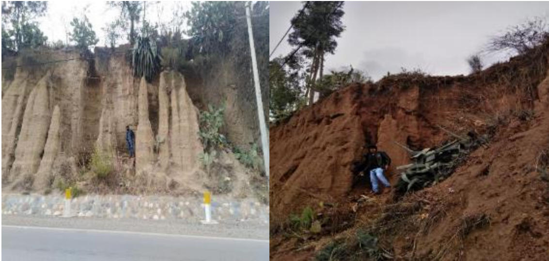
Figura 12. Falla de deslizamientos y deterioros de taludes
