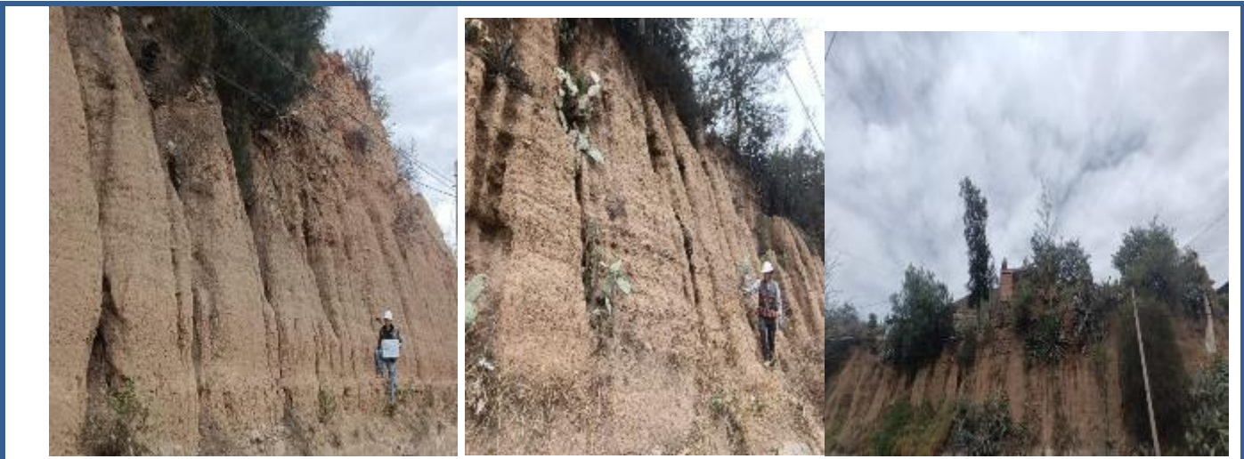
Octubre del 2022 Factores presentados de riesgo de deslizamiento de talud
