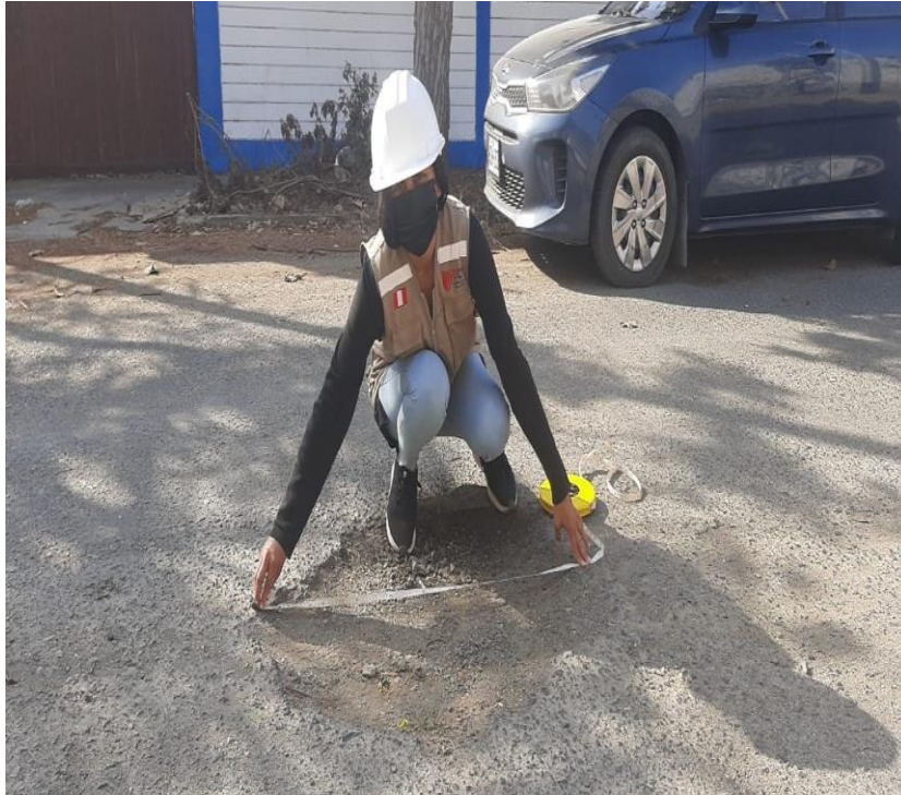
Medida del ancho de la falla en la calzada – Jr. Inti Raymi – Fuente: elaboración propia (2022)
