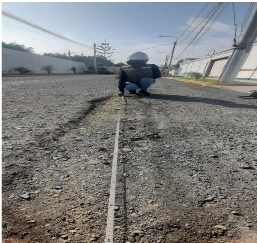
Medida del ancho de la falla en la calzada – Jr. Huambacho – Fuente: elaboración propia (2022)
