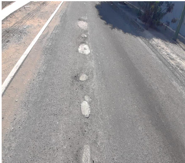
Identificación del tipo de falla en la calzada - Fuente propia (2022).
