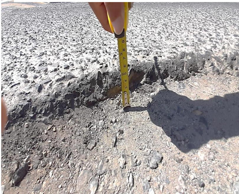
Profundidad de la falla encontrada en la calzada – Fuente propia (2022)
