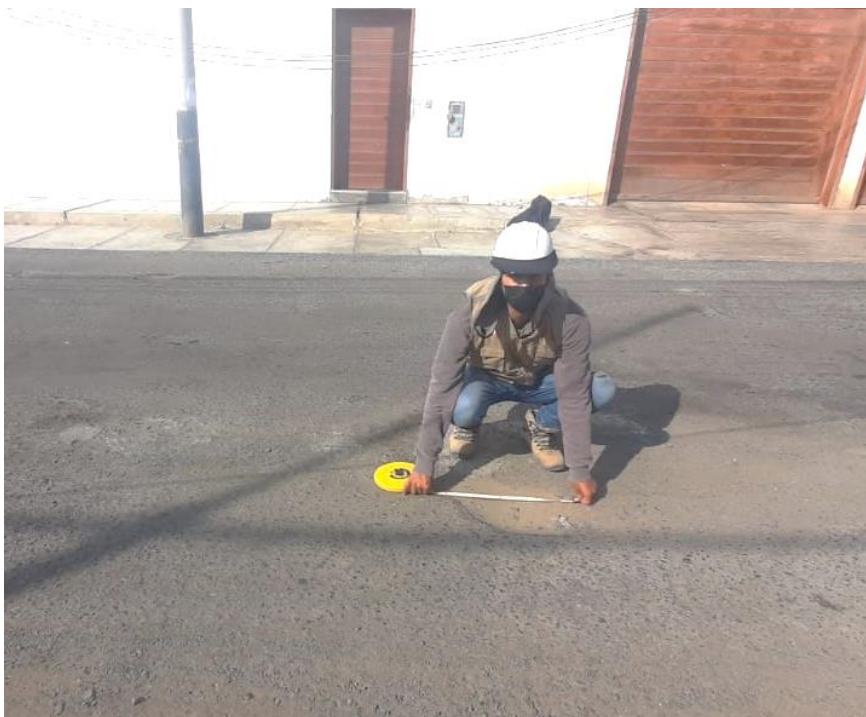
Medida del ancho de la falla en la calzada – Jr. Huambacho – Fuente: elaboración propia (2022)
