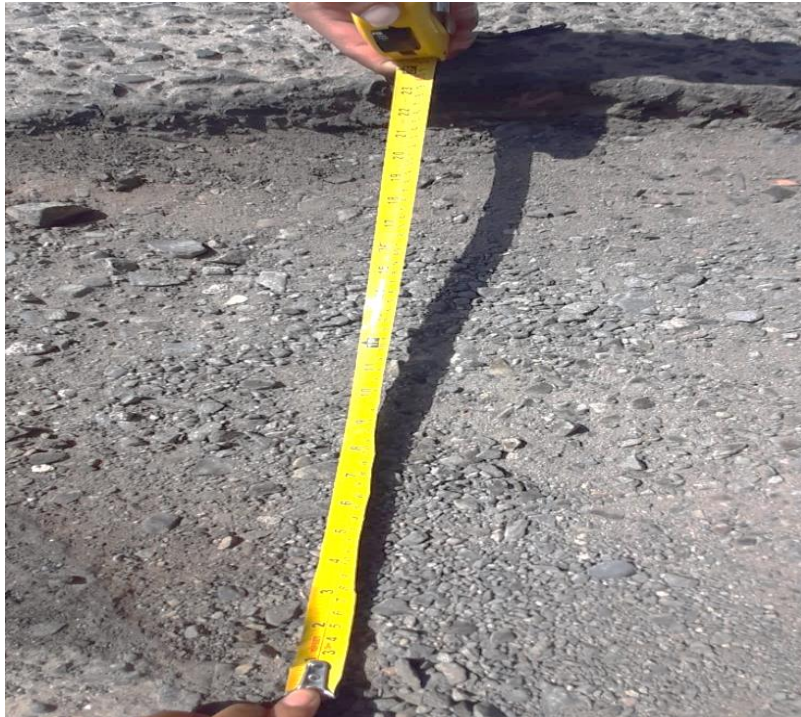
Identificación del tipo de falla en la calzada - fuente propia (2022).
