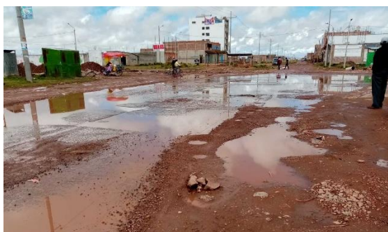
Figura 1. Estado actual de la vía
