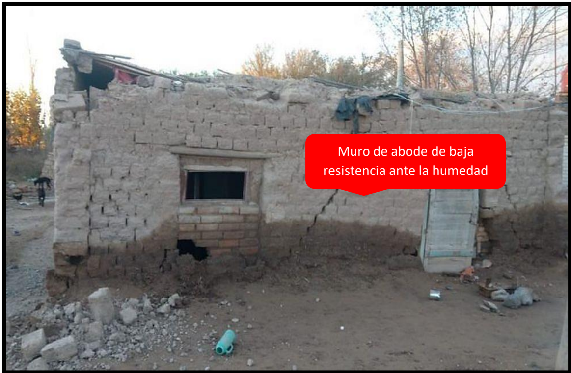
Figura 2. Problemática de los muros de adobe. (Currarino y Cerdan, 2021, p. 3).
