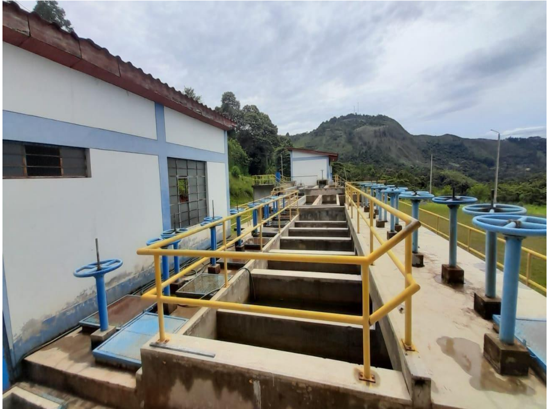
Figura 11. Batería de filtros de la planta de tratamiento
