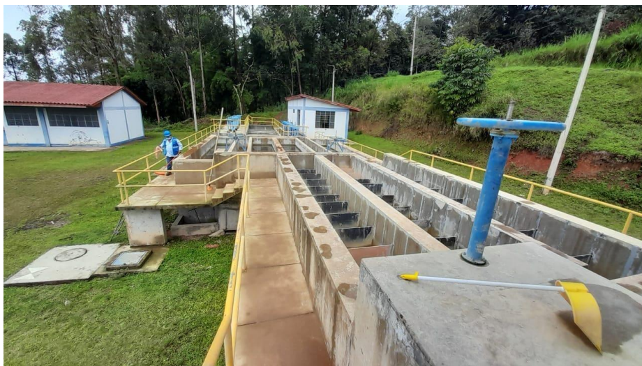
Figura 12. Planta de tratamiento de agua potable.
