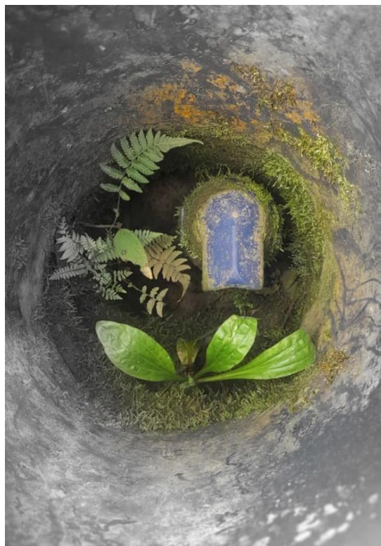
Figura 10. Estado de conservación en que se encuentra las válvulas de aire de doble efecto de la línea de conducción
