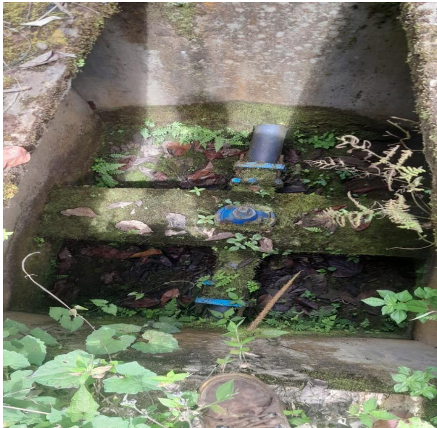
Figura 8. Estado en que se encuentra una válvula de purga de HD de DN 110mm
