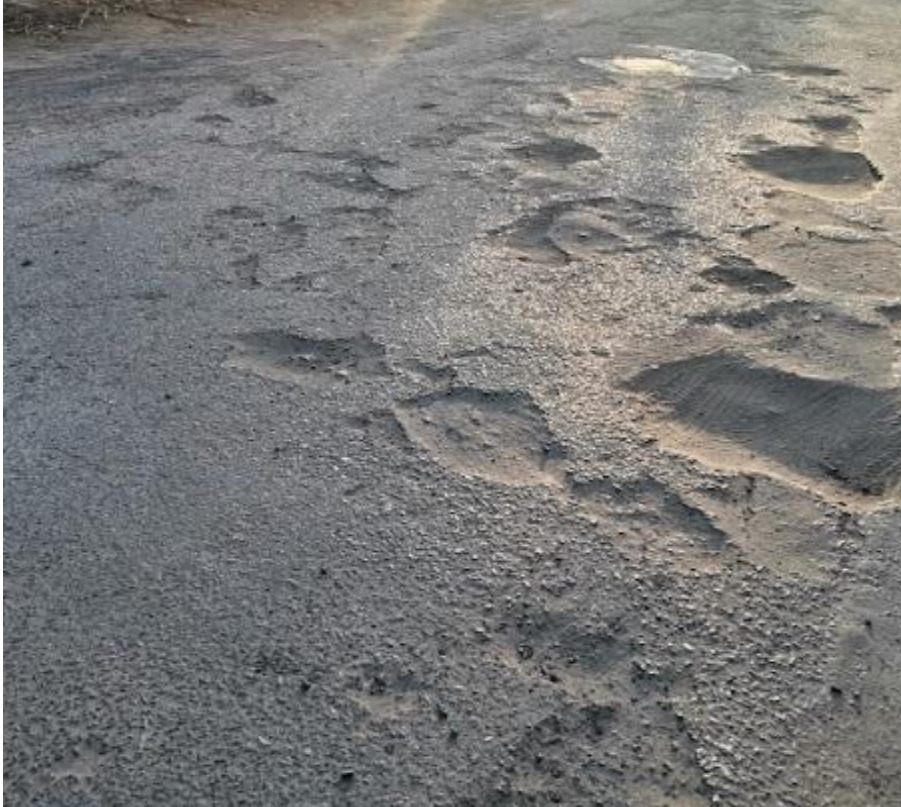
ANEXO N°110: Falla (Baches)
