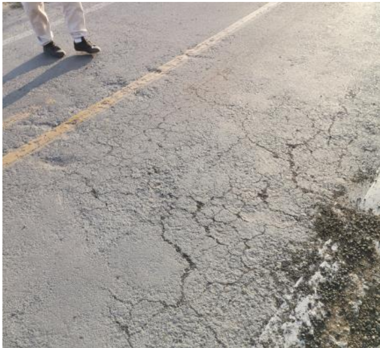
ANEXO N°111: Falla (Piel de Cocodrilo)
