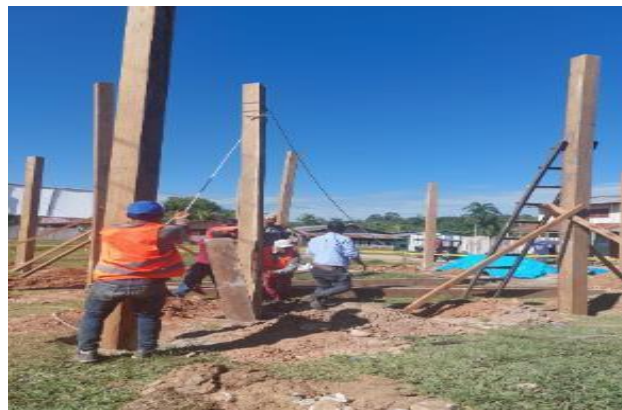
Figura 12. Zona de trabajo desordenado y trabajadores sin EPPS.
