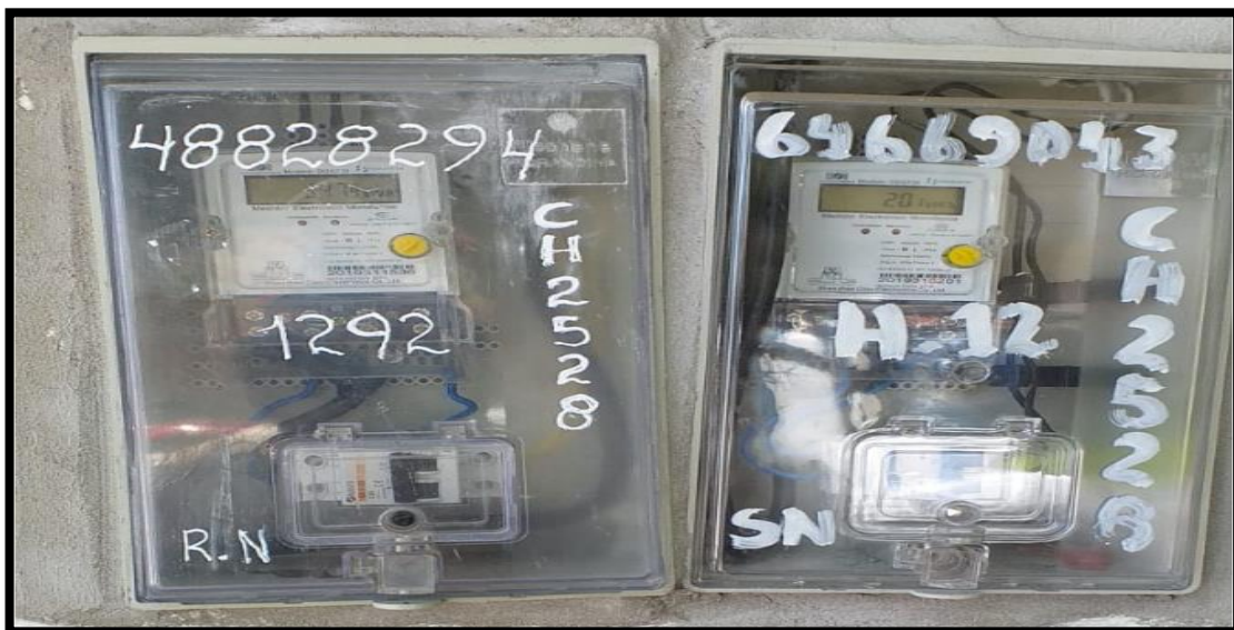
Ilustración 2: Caja porta medidor antifraude. fuente propia
