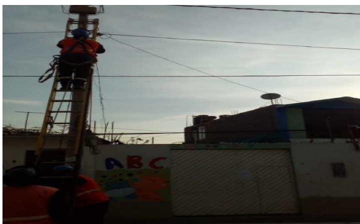
Ilustración 1 Conexión clandestina Fuente Propia
