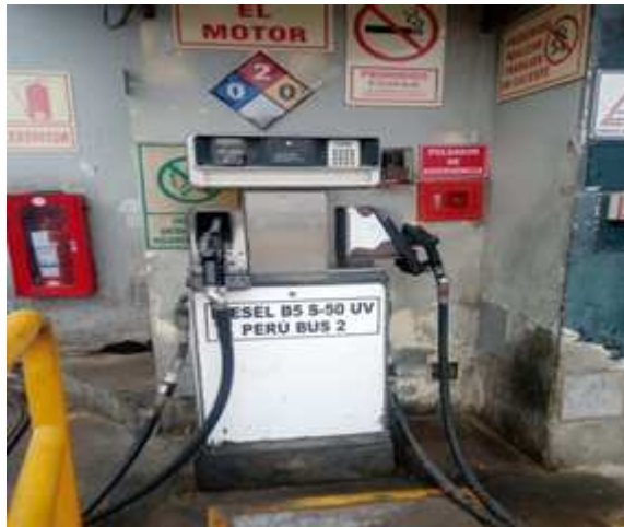
Área de grifo para el abastecimiento de combustible
