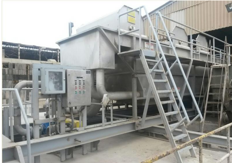
Figura 32. Sistema de recuperación de agua.
