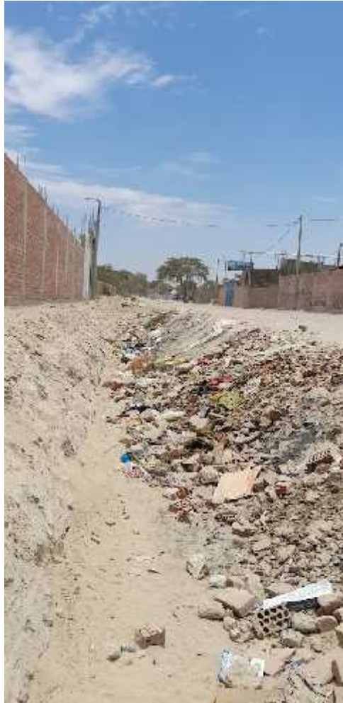
FIGURA N°5: Dren donde desfogon las aguas de la Av. Integradora Norte en mal estado.
