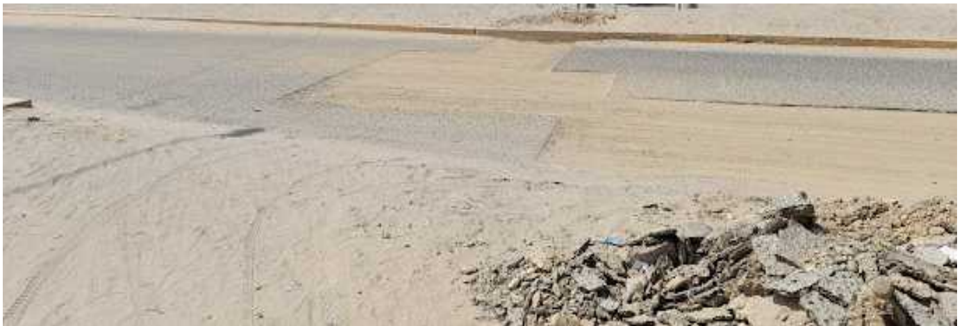
FIGURA N°6: Av. Integradora Norte con deformaciones.
