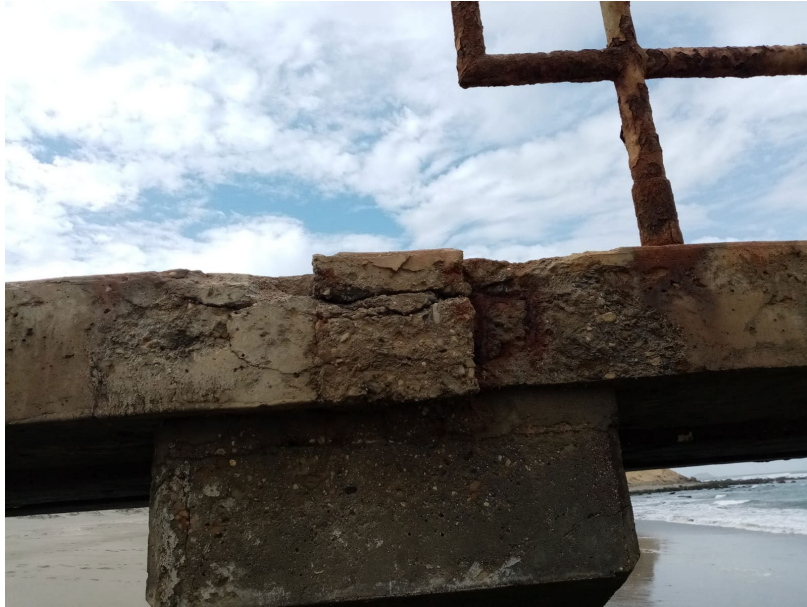
Descripción: Grietas en losas del muelle artesanal.
