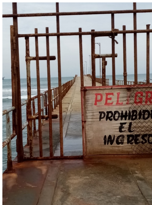
Descripción: Cartel de Peligro en muelle artesanal.
