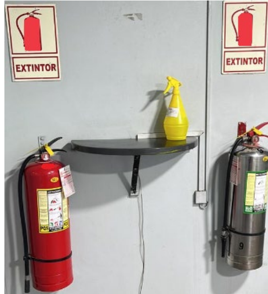
Figura 19. Control de extintores
