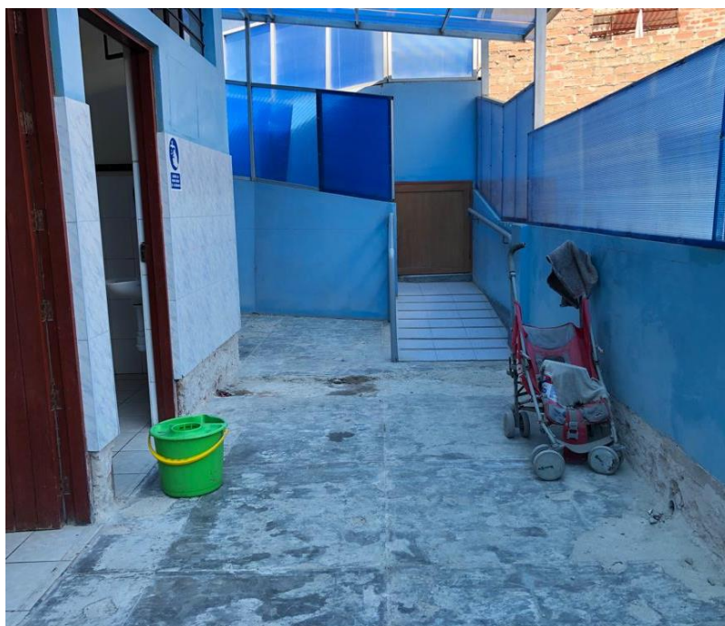
Inadecuado tratamiento de los acabados ocasionando problemas de seguridad.
