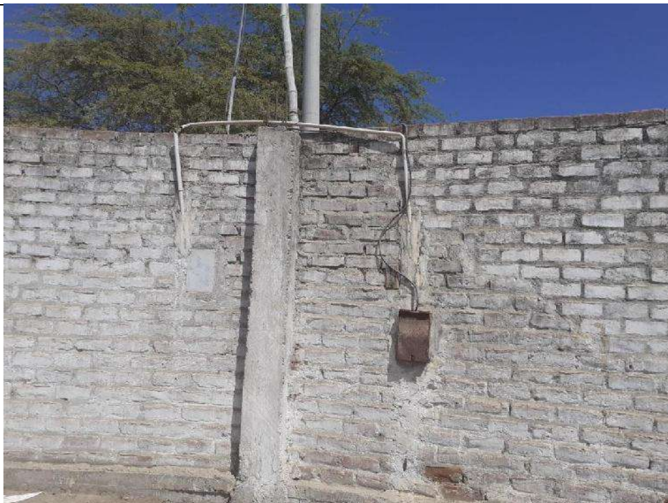
FOTOGRAFIA N°8: Se observa la inadecuada y precaria conexión eléctrica en la losa deportiva Jiménez- Malingas-Piura,2022
