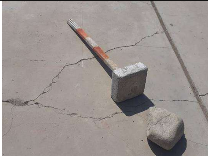
FOTOGRAFIA N°7: Vista de la losa deportiva con el 65% de la base se encuentra en mal estado ya que presentan levantamientos superficiales y esto genera que la capa de concreto se comience a presentar grietas.
