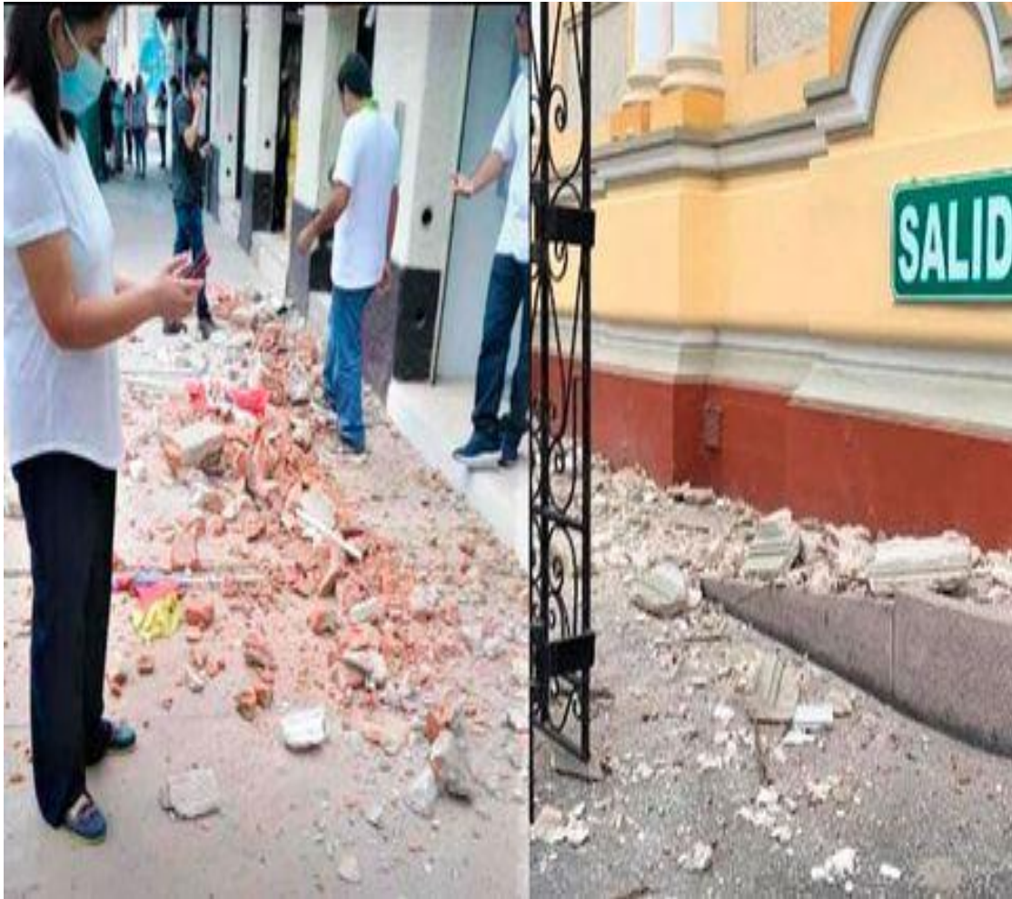
Figura 3. Vista de daños en viviendas por sismo
