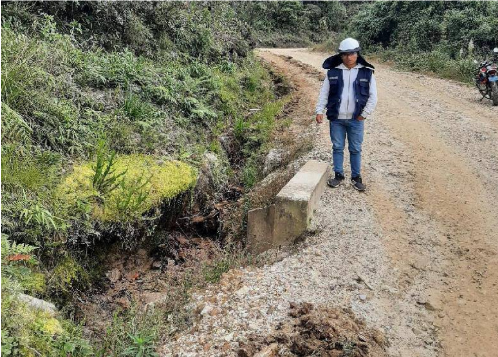
Imagen 03: Alcantarillas colapsadas de sedimentos.
