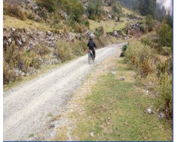
Fotografía 2: Fallas en la carpeta de rodadura
