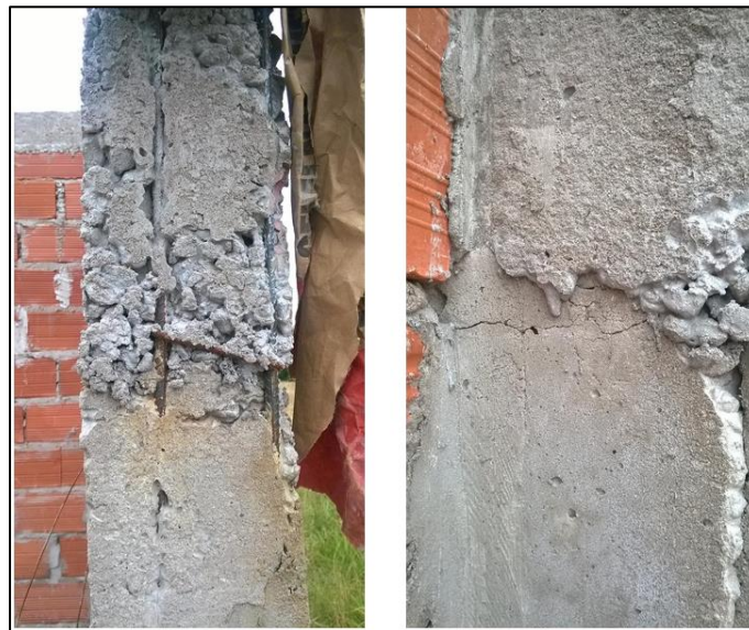
Errores estructurales en viviendas autoconstruidas
