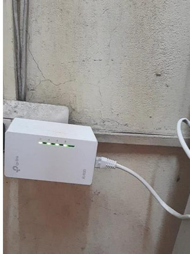
Figura 17. Vista del dispositivo Power Line comunicaciones conectado a la toma de corriente del área administrativa de Subdirección de primaria. Adaptada de “Diseño De Una Red LAN En La Institución Educativa Túpac Amaru – Tumbes”, por Lopez Eric. 2018, p. 112.
