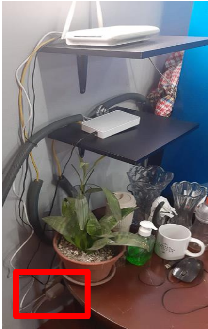
Figura 15. Vista de la conexión principal del Power Line communications al Router del área administrativa de Dirección. Adaptada de “Diseño De Una Red LAN En La Institución Educativa Túpac Amaru – Tumbes”, por Lopez Eric. 2018, p. 112.
