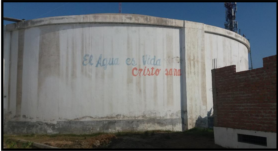
FOTOGRAFÍA N° 05: Se inspecciono los reservorios RII A, B y C, en las cuales los reservorios RII A y B presenta rajaduras.
