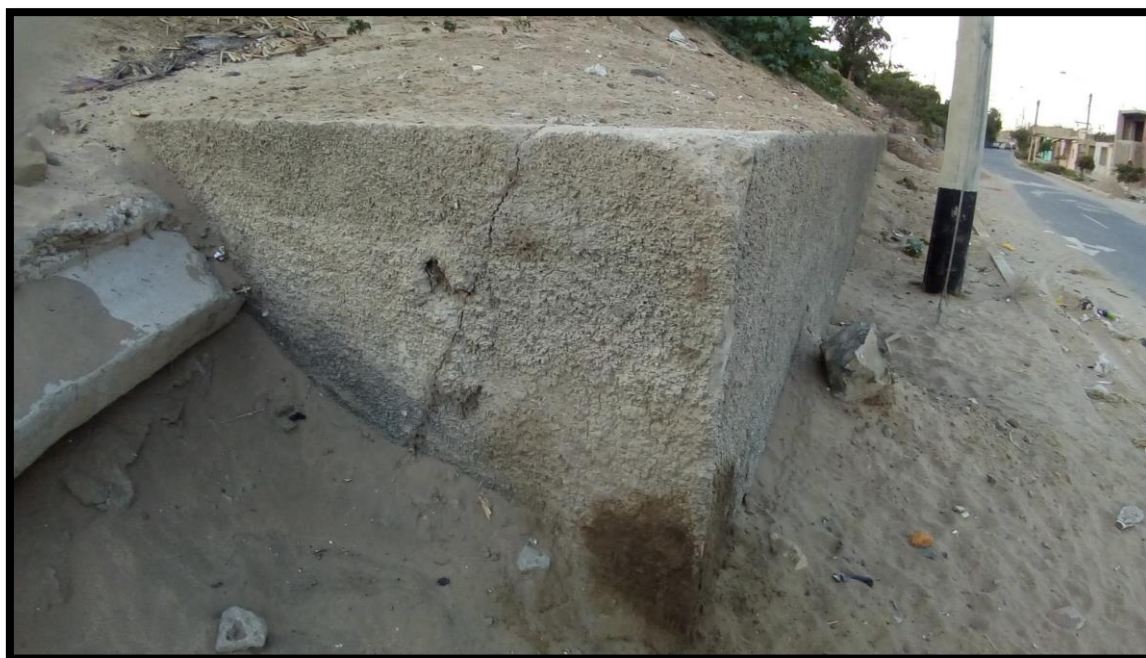
Figura 2: A simple vista, el inicio del muro de contención se encuentra en mal estado y presenta rajaduras y sobre todo el mal cuidado por parte de los pobladores de esta zona.
