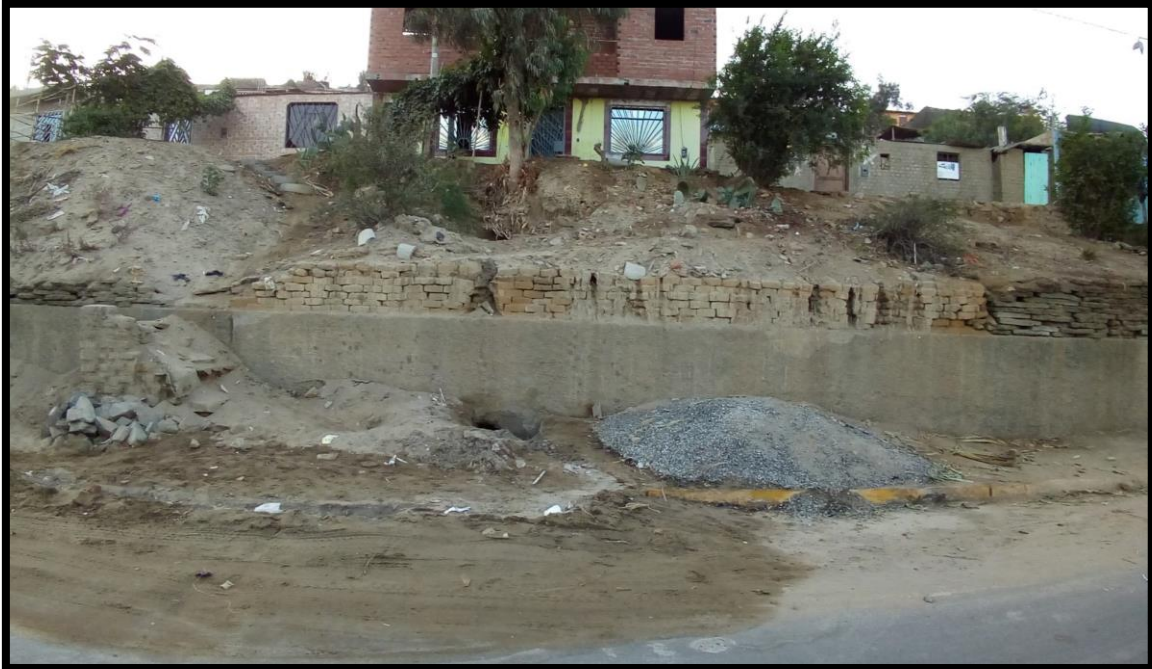
Figura 4: Se puede observar el mal estado del relleno encima del muro, lo cual no es nada seguro, generando una sobrecarga al muro lo cual trae como consecuencia a la contracción del concreto.
