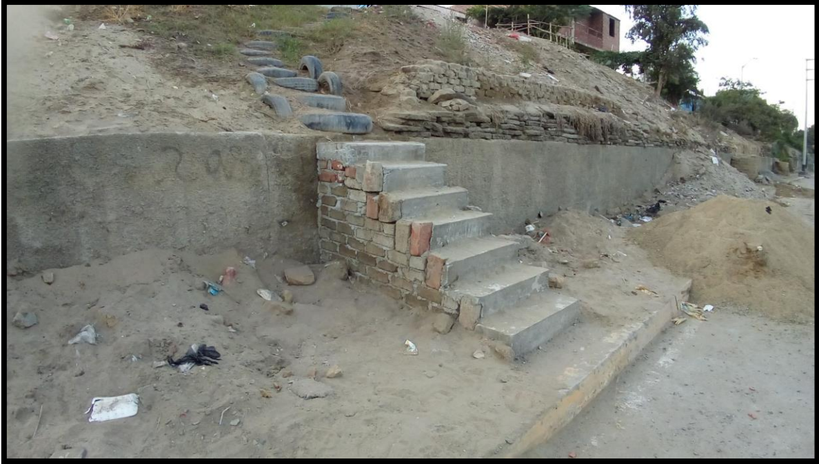
Figura 3: En algunas partes del muro, los pobladores decidieron poner una escalera que no garantiza nada de seguridad y sobre todo el relleno que hicieron con adobe lo cual puede deslizarse en cualquier momento.
