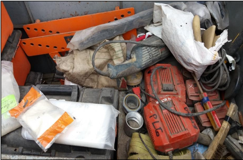
Figura 7. Herramientas eléctricas mal ubicadas Fuente: Elaboración propia
