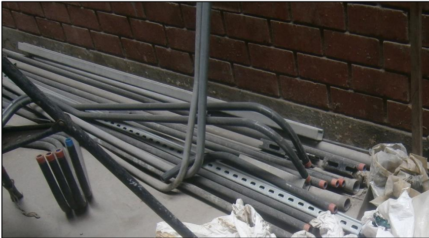
Figura 13. Tuberías conduit y PVC Fuente: Elaboración propia
