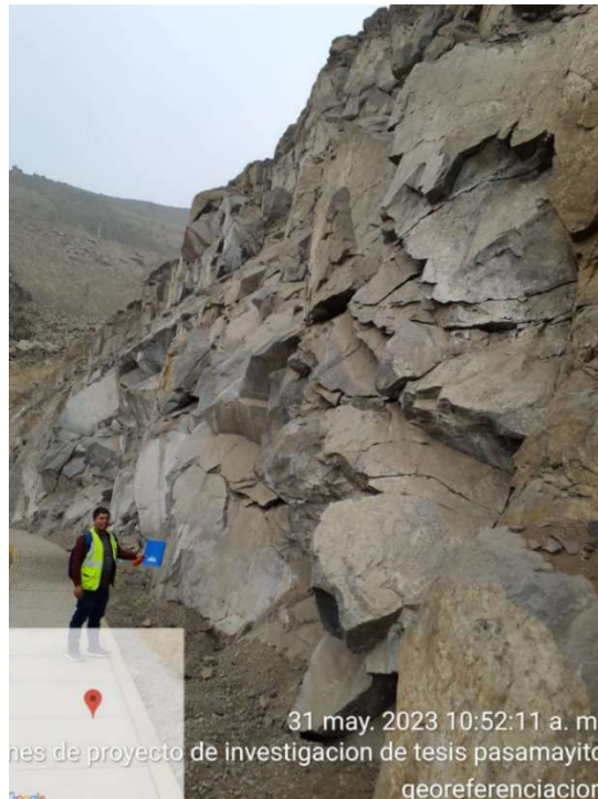
Figura 20. Pendiente elevado con roca suelta
