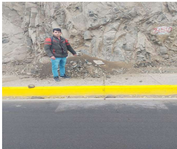
Figura 22. Tierra con grava deslizada
