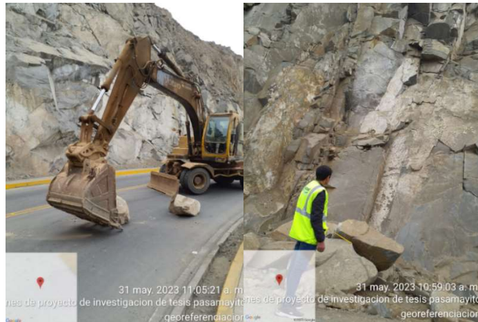
Figura 21. Roca deslizada en la calzada
