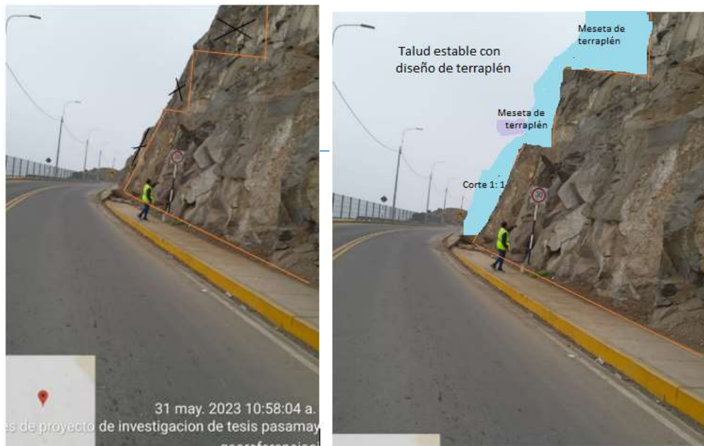
Figura 24. Riesgo de caída de rocas, diseño de terraplenes
