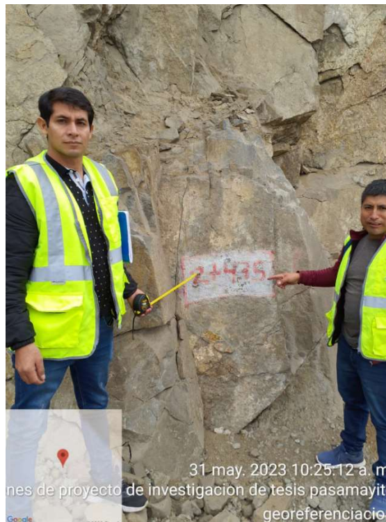
Figura 2. Roca suelta por deslizarse en varios tramos de la vía
