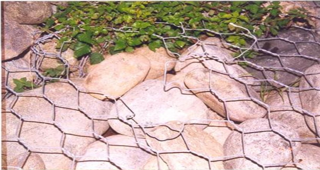
Figura N°2. Deterioro de la Malla producto de la abrasión
