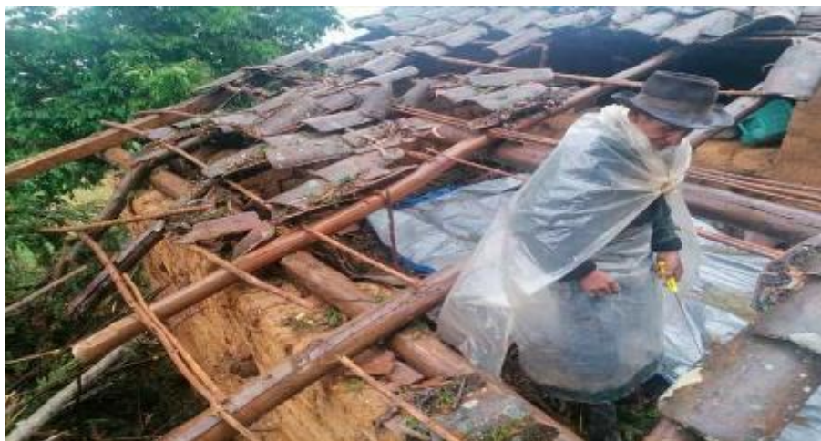
Figura 5. Techos con deficiencias por ser autoconstrucciones
