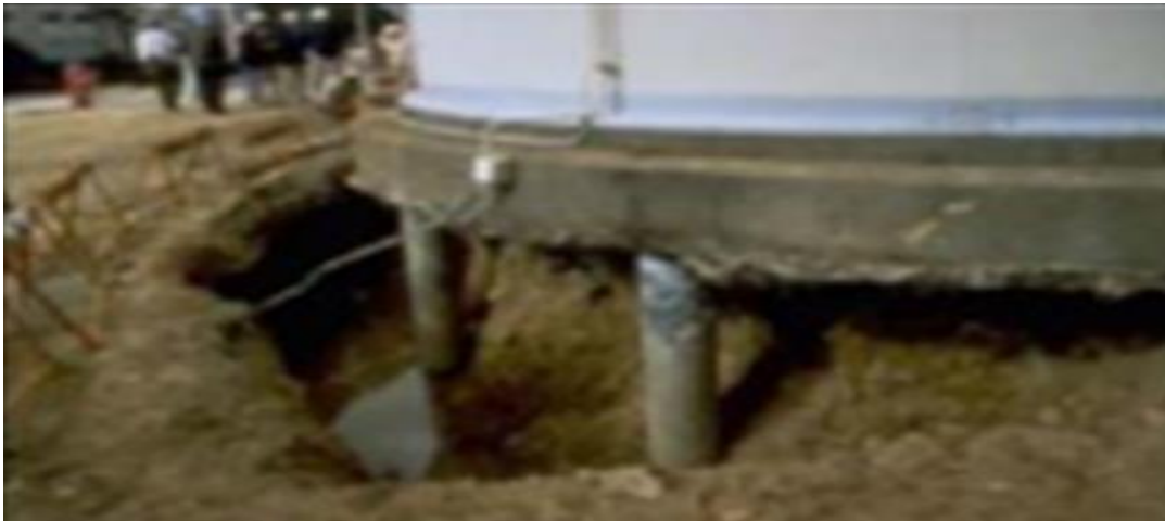
Figura N° 3: Reservorio apoyado, falla en la cimentación por licuefacción
