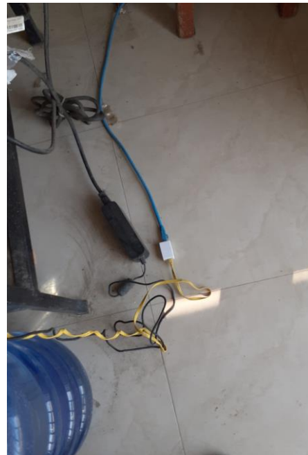
Cables mal conectados, lo cual genera que el equipo se apague cada que se realiza una operación.
