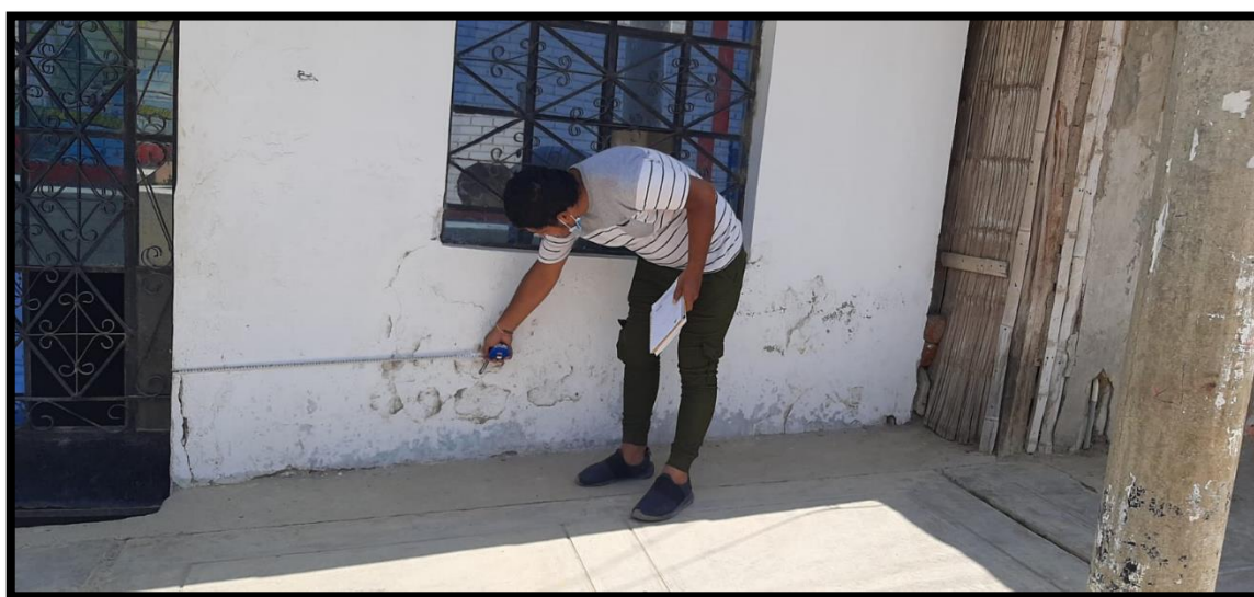
Vivienda 02: Muro confinado afectado por eflorescencia
