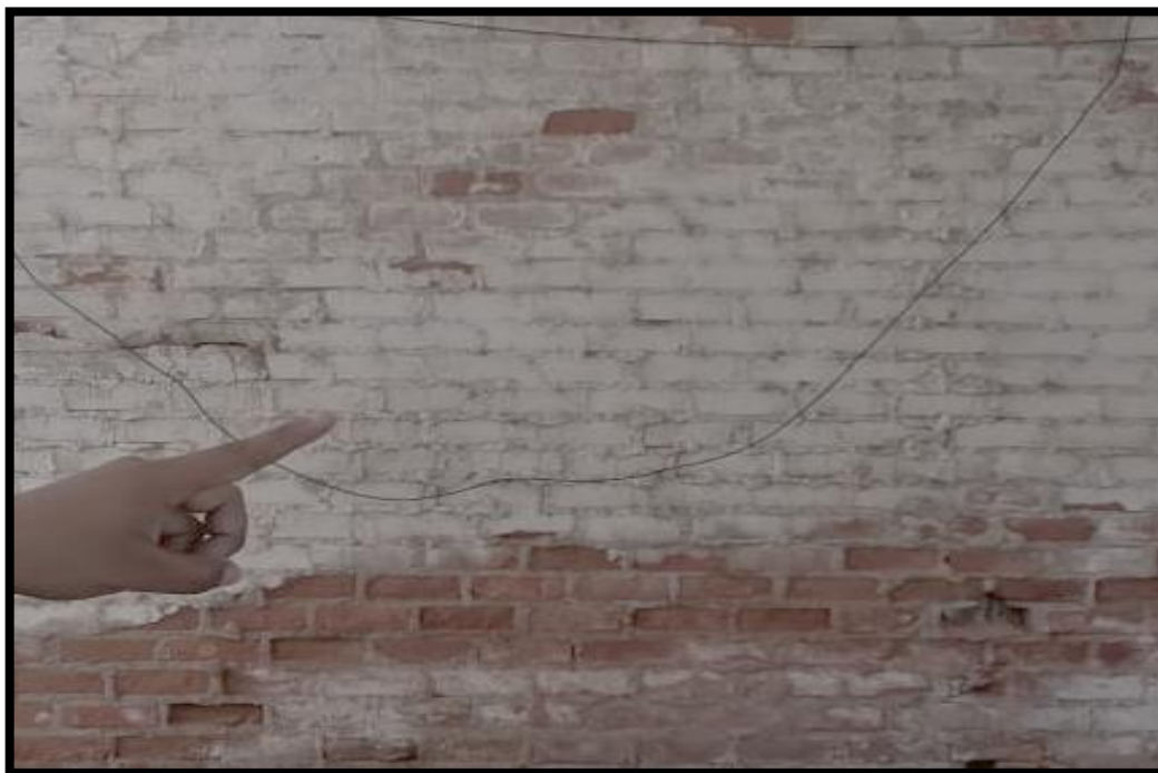
Vivienda 04: Muro confinado afectado por eflorescencia
