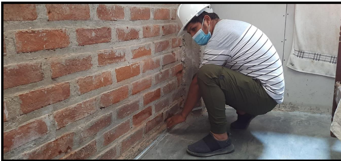
Vivienda 03: Muro confinado afectado por eflorescencia
