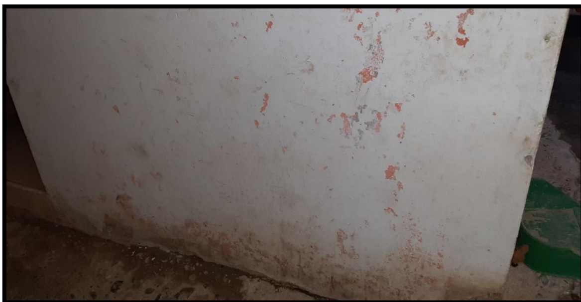
Vivienda 05: Muro confinado afectado por eflorescencia
