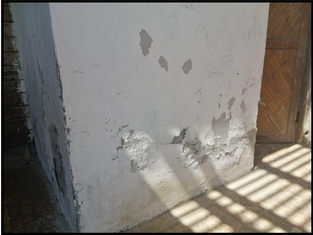
Vivienda 01: Muro confinado afectado por eflorescencia
