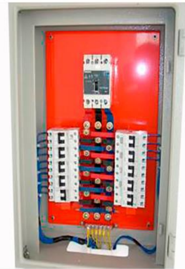
Figura 01: Tablero de Distribución general.
