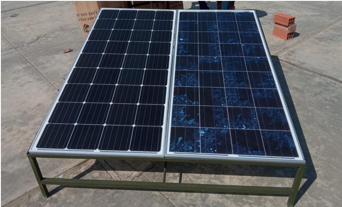
Instalación de los equipos y conexión para la recolección de datos
