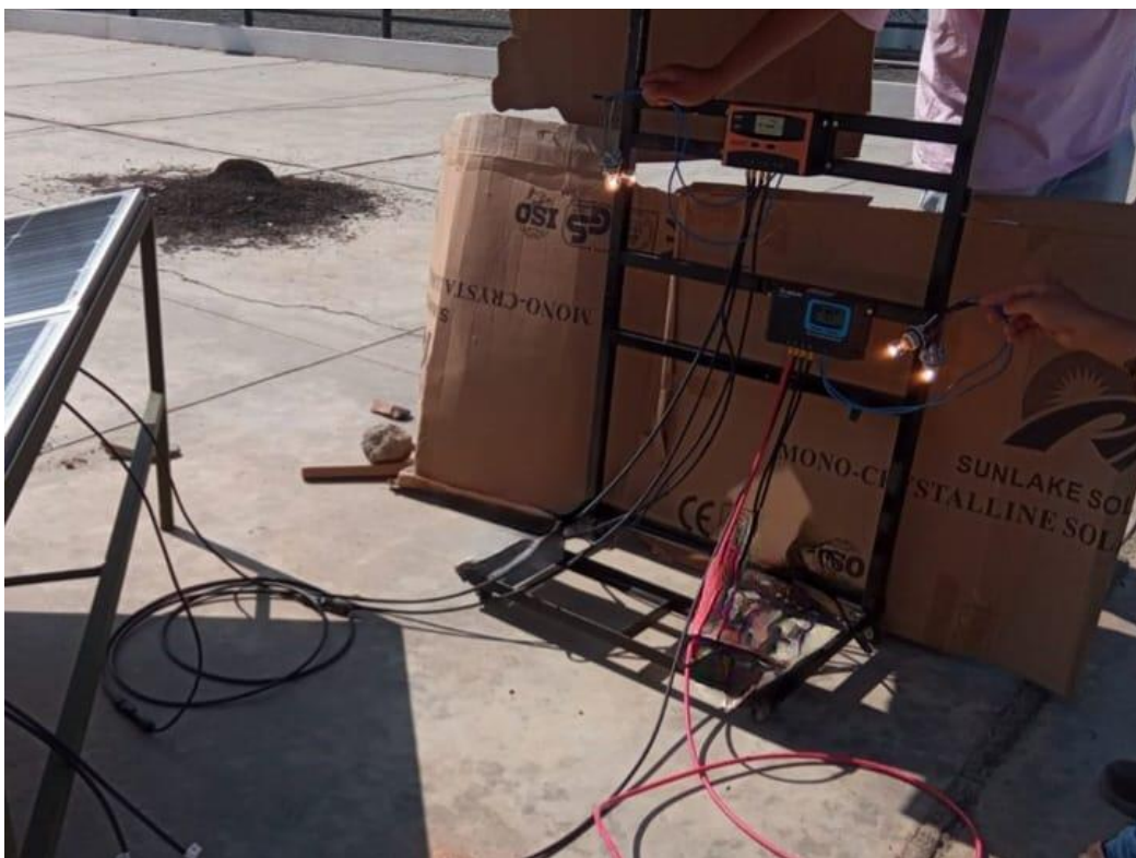
Controladores de carga conectados a sus respectivas cargas en corriente continua
