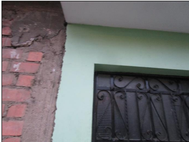
Inexistencia de junta sísmica
