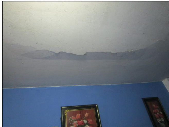
Grieta en fondo de losa aligerada de 1° piso
