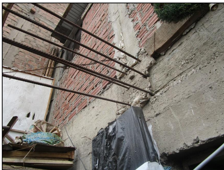
Figura 3.11 – Acero de refuerzo de viga expuesto a la intemperie (Fuente: Elaboración propia)
