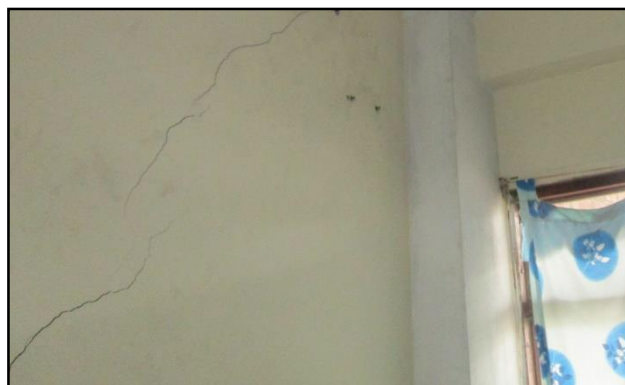
Figura 3.3 – Presencia de rajaduras en muro de albañilería confinada (Fuente: Elaboración propia)
