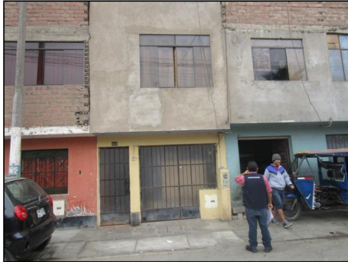
Figura 3.6 – Ausencia de junta sísmica y techo a desnivel (Fuente: Elaboración propia)
