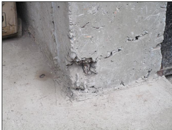
Cangrejera y exposición de acero en base de columnas
