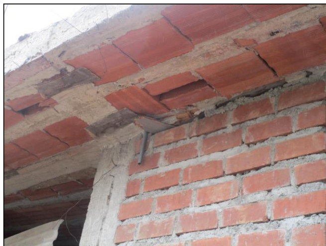
Mala calidad de la mano de obra
