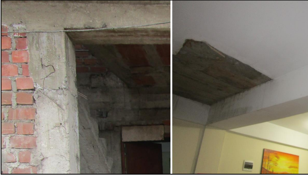
Figura 3.10 – Presencia de juntas frías en columna y losa (Fuente: Elaboración propia)
