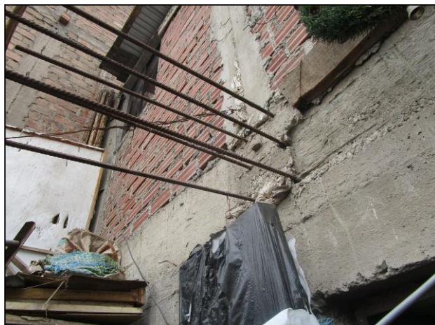
Corrosión del acero por exposición
