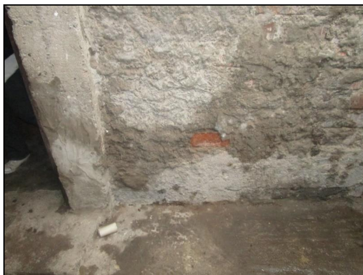
Figura 3.16 – Presencia de humedad en muro y columna (Fuente: Elaboración propia)
