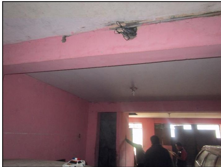
Figura 3.5 – Inadecuada densidad de muros en primer piso (Fuente: Elaboración propia)
