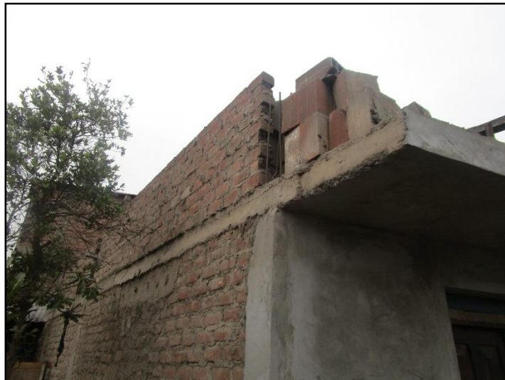
Figura 3.7 – Parapeto del segundo nivel no arriostrado (Fuente: Elaboración propia)
