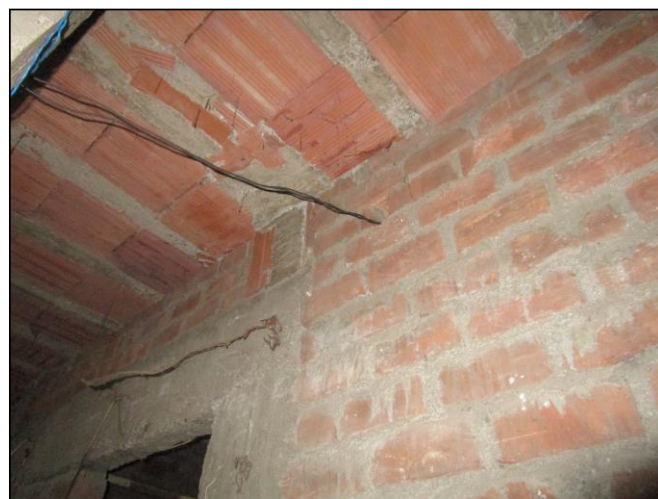
Muro de ladrillo KK artesanal con juntas mayores a 1.5 cm.
