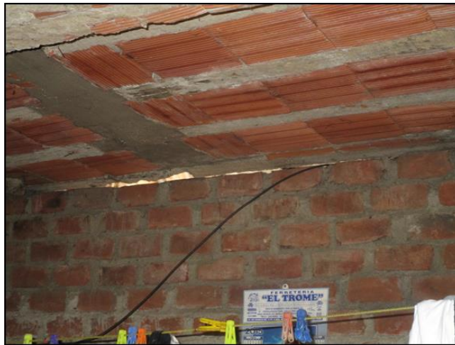
Muro sin arrioste y con juntas mayor a 1.5 cm.
