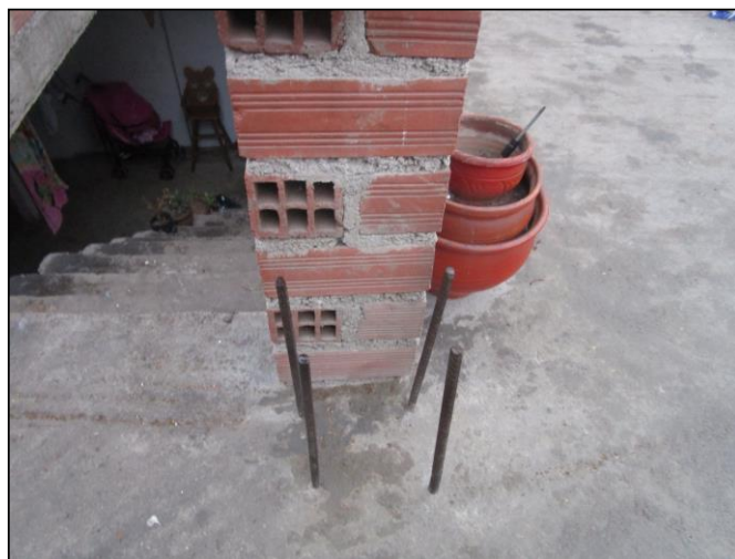
Acero de columna expuesto a la corrosión
