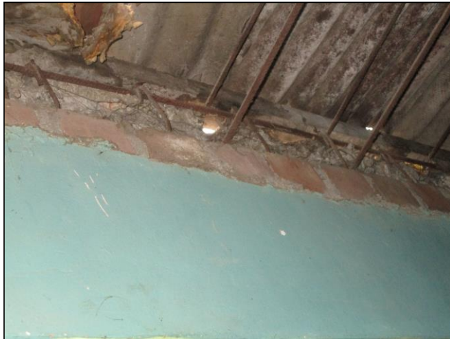
Corrosión del acero por exposición
