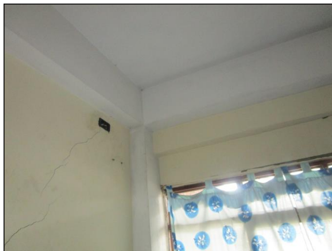
Grieta en muro portante
