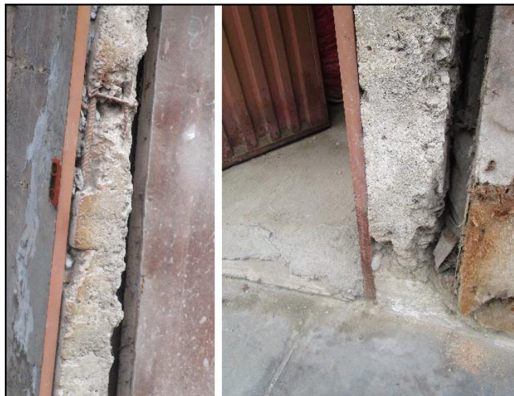
Figura 3.9 – Cangrejas en columna con exposición de acero de refuerzo (Fuente: Elaboración propia)
