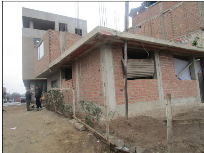
Palo de madera incrustado en losa aligerada
