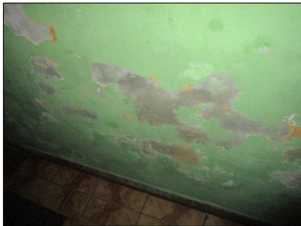
Eflorescencia en muro portante del 1° piso por humedad
