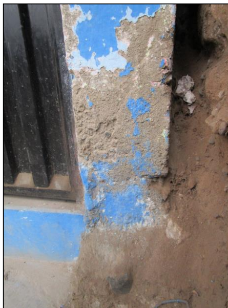
Desmoronamiento del concreto en columna
