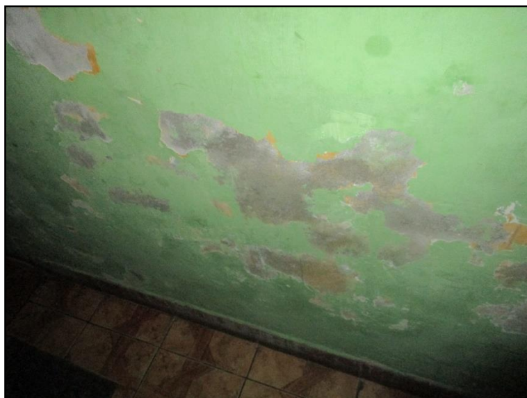
Figura 3.17 – Muro revestido con presencia de eflorescencia (Fuente: Elaboración propia)
