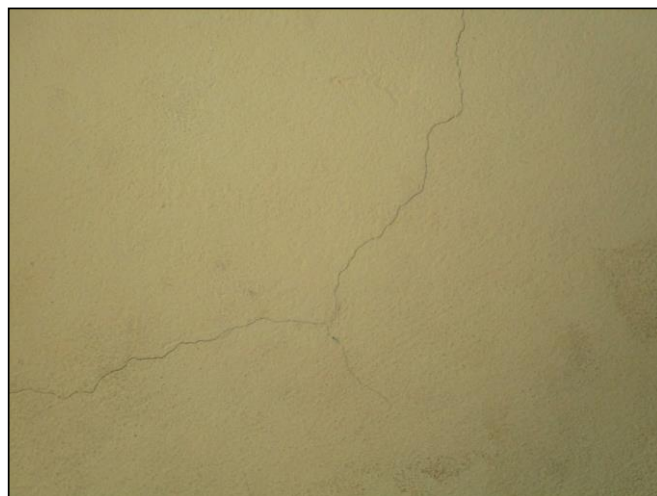
Fisura en muro de dormitorio 1
