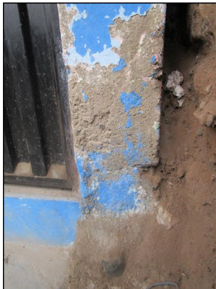
Desmoronamiento del concreto en columna
