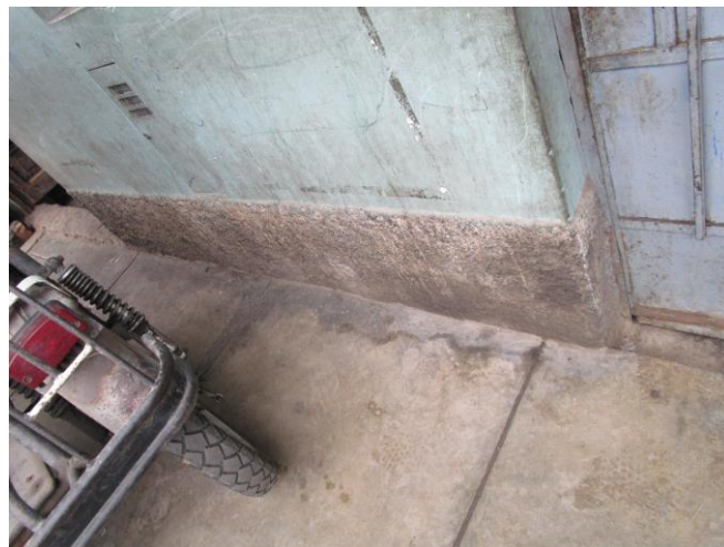
Eflorescencia de salitre en sobrecimiento
