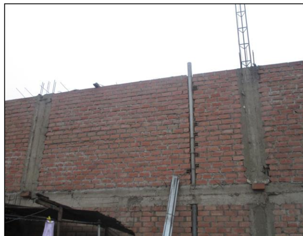
Muro portante de ladrillo pandereta y tubería de desagüe expuesta
