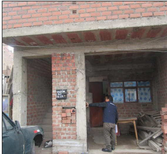
Junta fria en columnas
