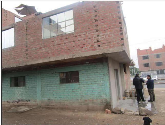
Desmoramamiento del concreto en sobrecimiento de fachada lateral
