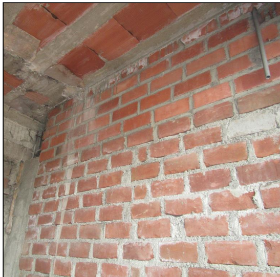
Muro de albañilería con juntas mayores a 1.5 cm.
