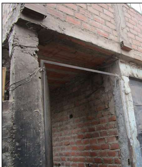
Muro de ladrillo KK artesanal con juntas mayor a 1.5 CM.
