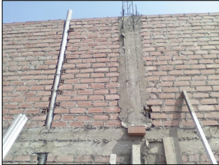
Figura 3.18 – Tubería PVC de desagüe expuesta (Fuente: Elaboración propia)
