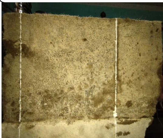
FOTO 83: ROTURA DE VIGAS
