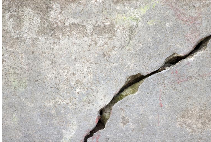
Figura 1.2: Agrietamiento Fuente: PAQSA (2022)
