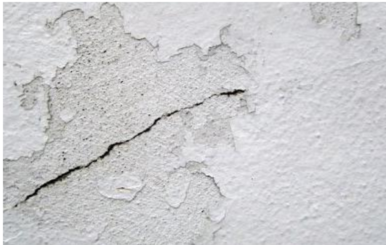
Figura 1.1: Fisura por contracción plástica Fuente: PAQSA (2022)
