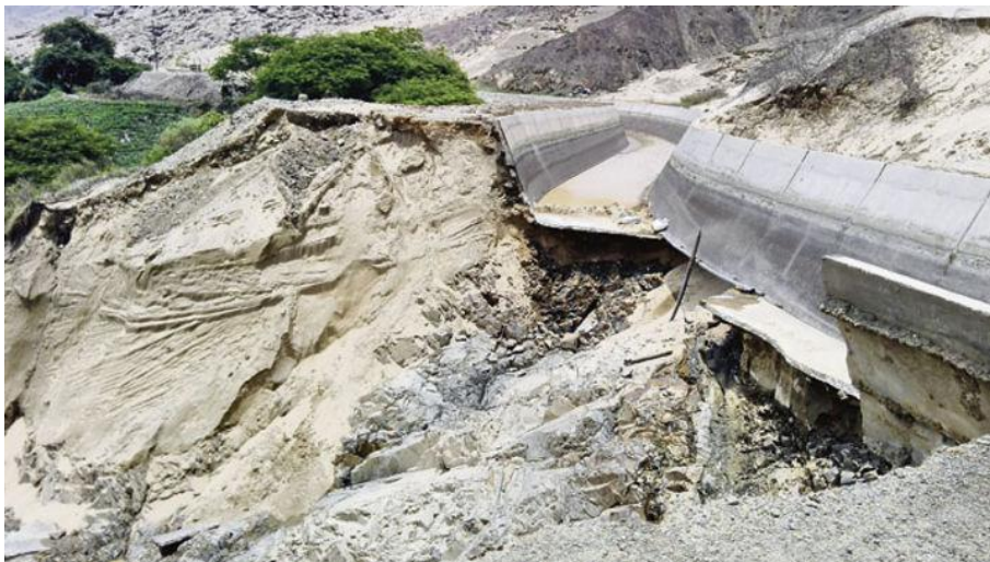
Figura I - 2. Inestabilidad de talud en zona de estructura de irrigación.
