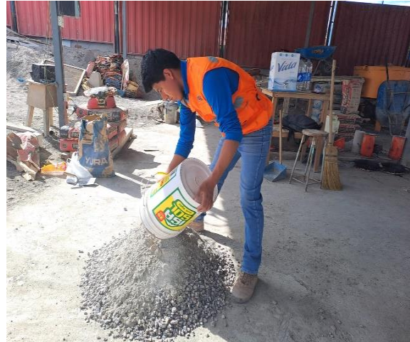
Fotografía N°38. Batido de la mezcla en seco gravilla 3/8", arena, cemento y ceniza de tallo de muña.
