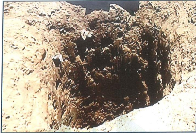
Imagen N° 01: Se aprecia la vista panorámica de la calicata C/1, para los ensayos correspondientes.
